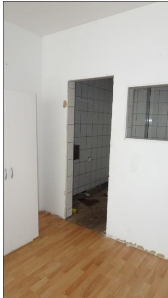
10) ungenehmigter Zugang zum Sondereigentum Nr. 4
