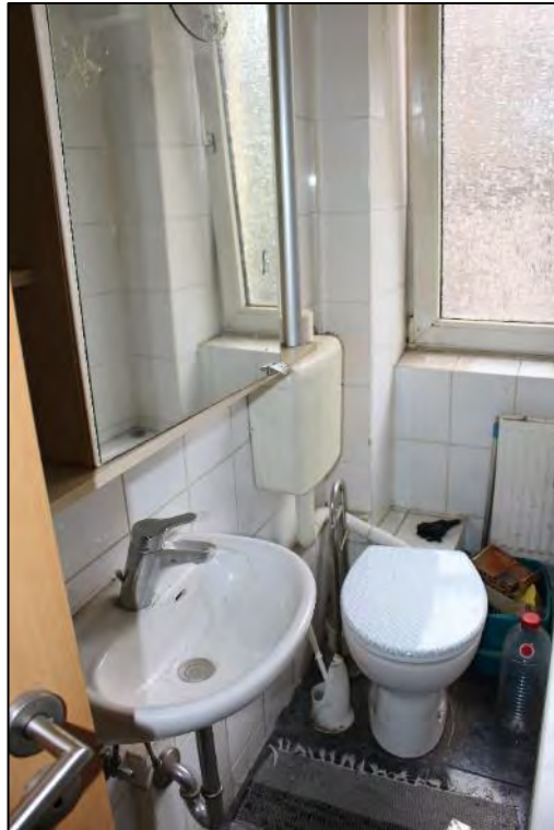
Foto Nr. 49: 1. OG mittig, ETW Nr. 2, Bad
