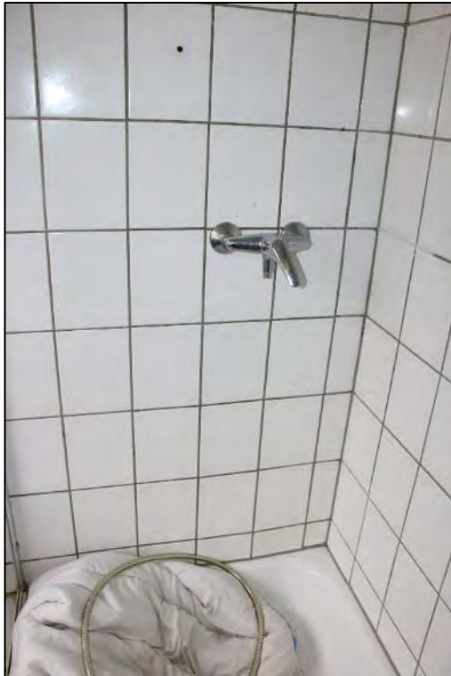
Foto Nr. 69: 2. OG mittig, ETW Nr. 5, Bad
