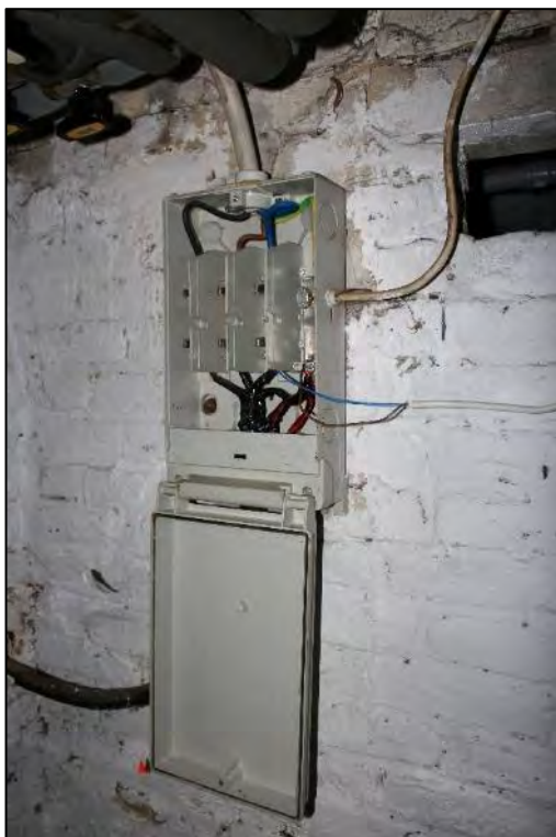
Foto Nr. 18: Kellergeschoss, Stromhausanschluss / Sabotage
