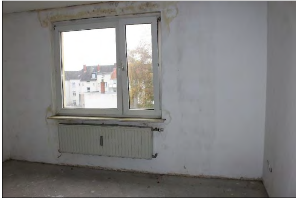
Foto Nr. 89: 3. OG rechts, ETW Nr. 7, Schlafen / Feuchteschäden
