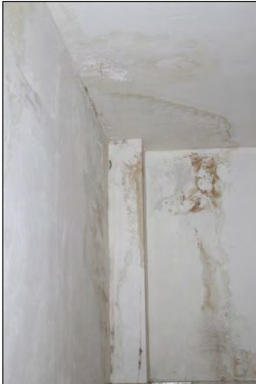
Foto Nr. 55: 1. OG links, ETW Nr. 3, Küche / Feuchteschäden
