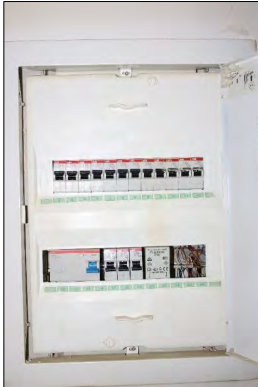
Foto Nr. 35: Teileigentum Nr. 13, Eingang Königsberger Straße 36 a, Elektrounterverteilung
