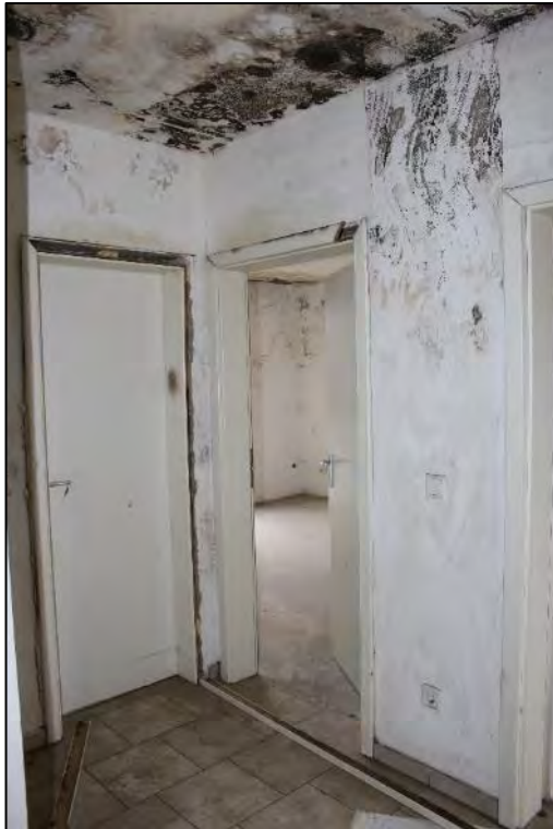
Foto Nr. 85: 3. OG rechts, ETW Nr. 7, Diele / Feuchteschäden
