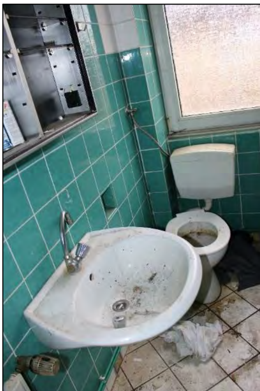
Foto Nr. 98: 3. OG mittig, ETW Nr. 8, Bad
