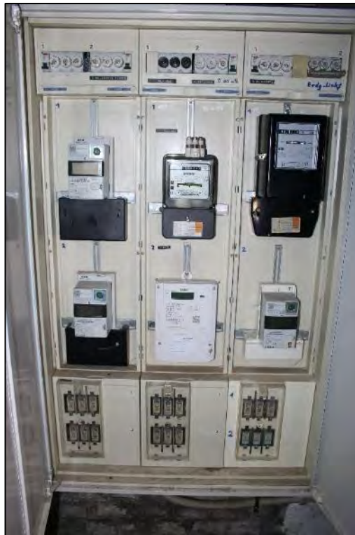
Foto Nr. 19: Kellergeschoss, Elektrounterverteilung
