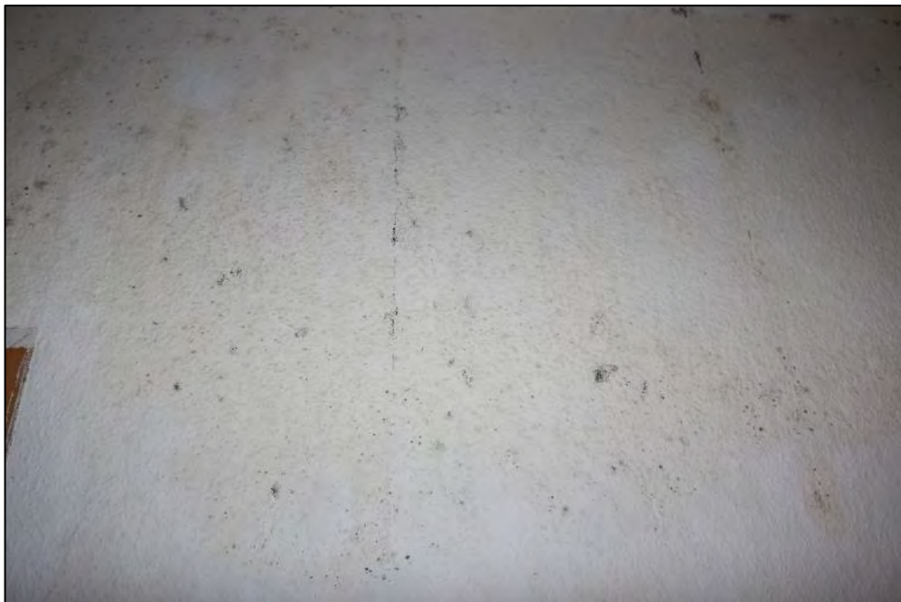
Foto Nr. 74: 2. OG links, ETW Nr. 6, Diele / Feuchteschäden
