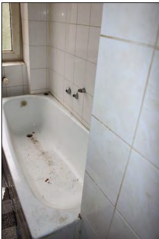
Foto Nr. 48: 1. OG mittig, ETW Nr. 2, Bad
