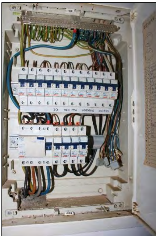
Foto Nr. 60: 2. OG rechts, ETW Nr. 4, Elektrounterverteilung
