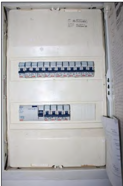
Foto Nr. 82: 3. OG rechts, ETW Nr. 7, Elektrounterverteilung
