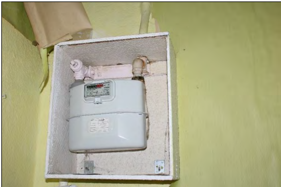
Foto Nr. 96: 3. OG mittig, ETW Nr. 8, Gaszähler
