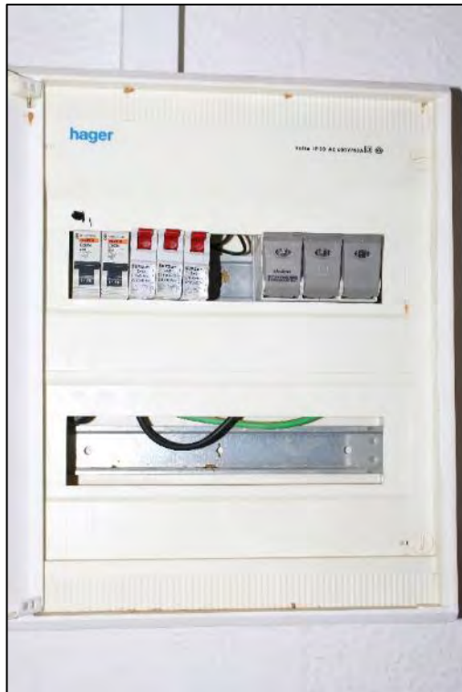
Foto Nr. 75: 2. OG links, ETW Nr. 6, Elektrounterverteilung
