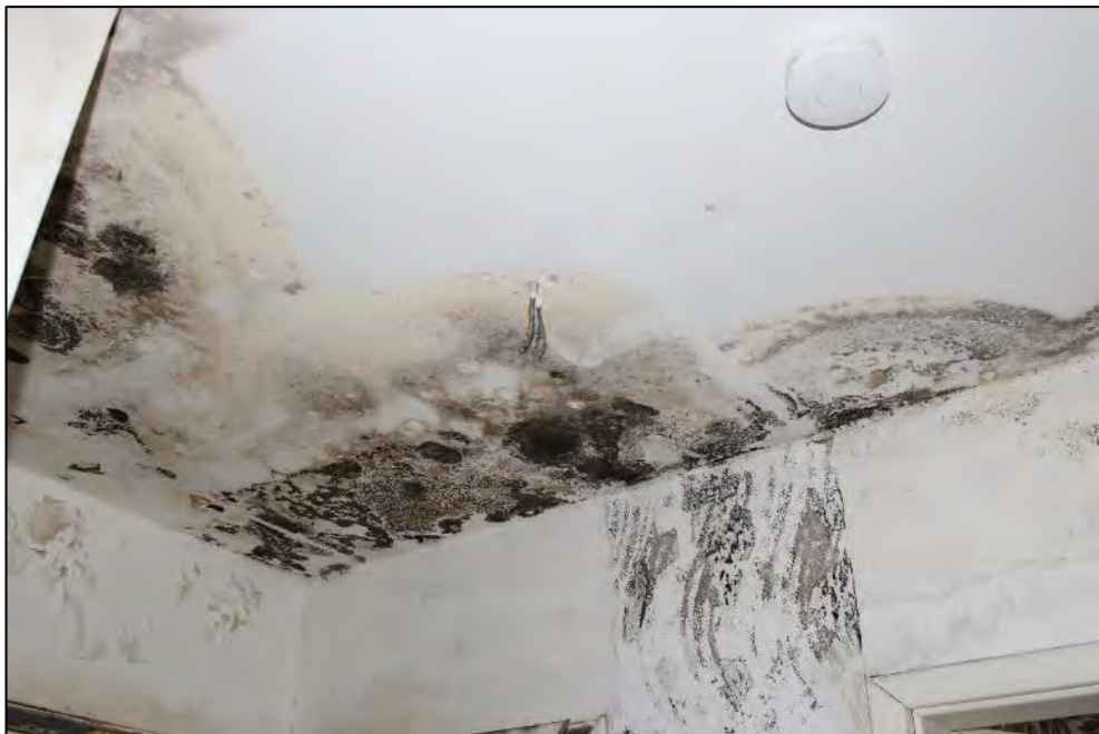
Foto Nr. 84: 3. OG rechts, ETW Nr. 7, Diele / Feuchteschäden
