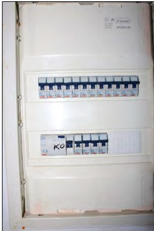
Foto Nr. 39: 1. OG rechts, ETW Nr. 1, Elektrounterverteilung
