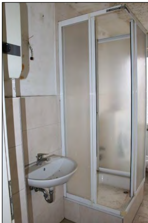
Foto Nr. 92: 3. OG rechts, ETW Nr. 7, Bad / Feuchteschäden
