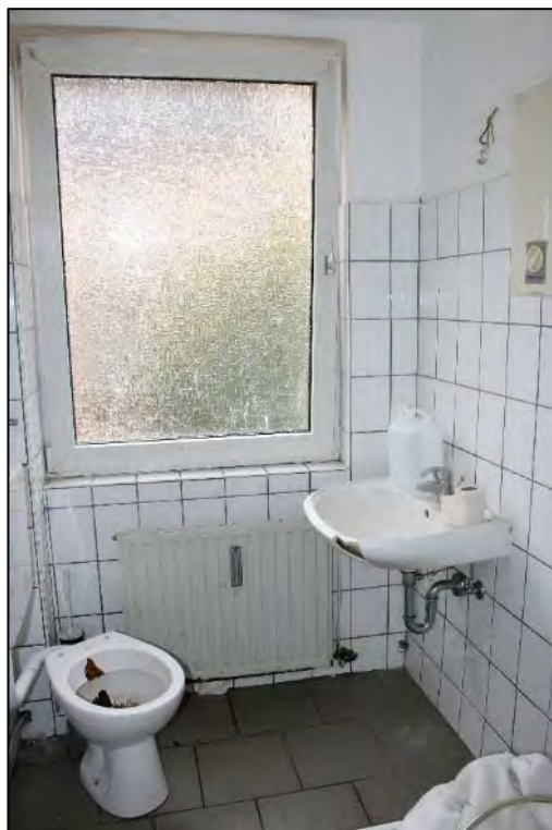
Foto Nr. 68: 2. OG mittig, ETW Nr. 5, Bad
