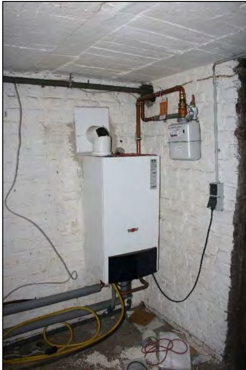
Foto Nr. 13: Kellergeschoss, Heizungsraum
