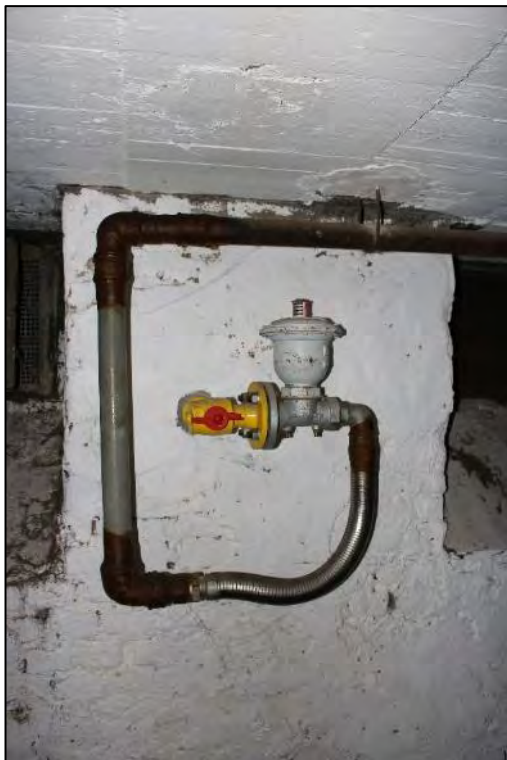
Foto Nr. 14: Kellergeschoss, Gashausanschluss
