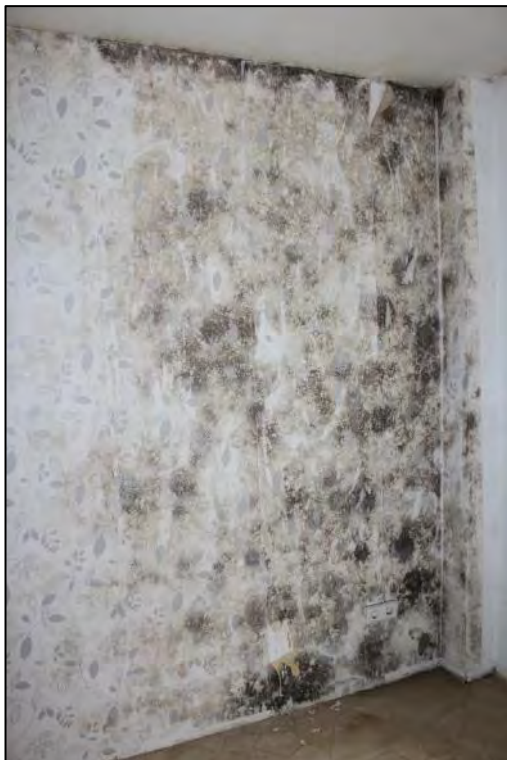
Foto Nr. 86: 3. OG rechts, ETW Nr. 7, Wohnzimmer / Feuchteschäden
