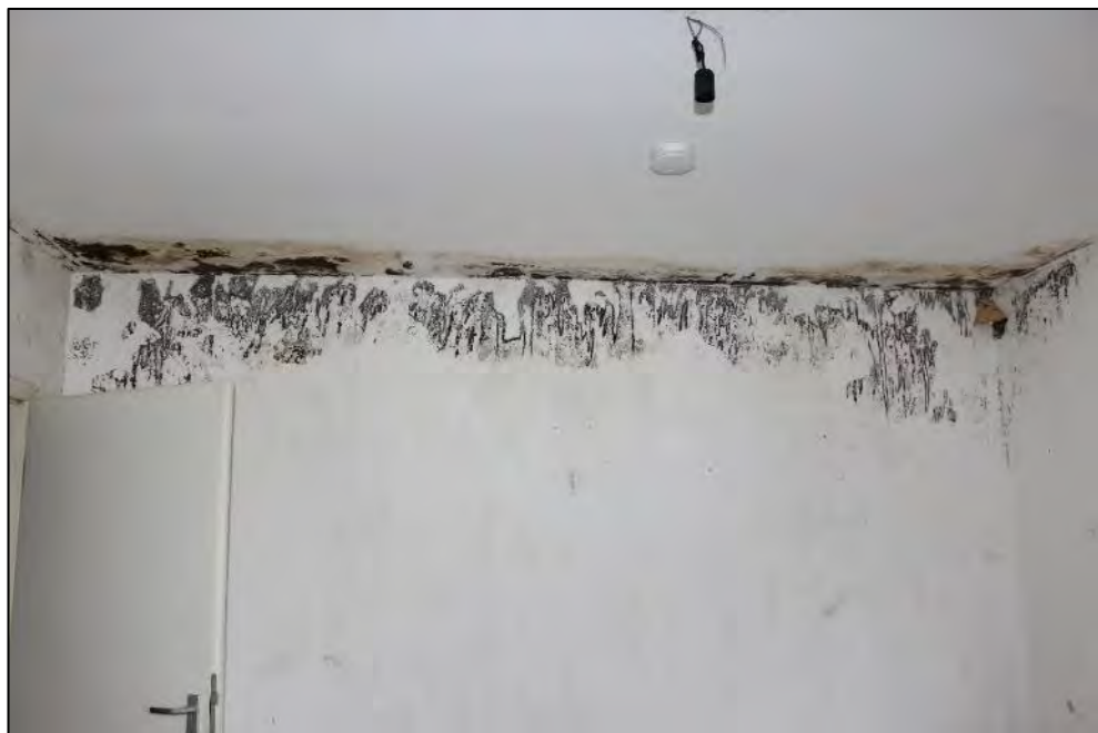
Foto Nr. 90: 3. OG rechts, ETW Nr. 7, Schlafen / Feuchteschäden
