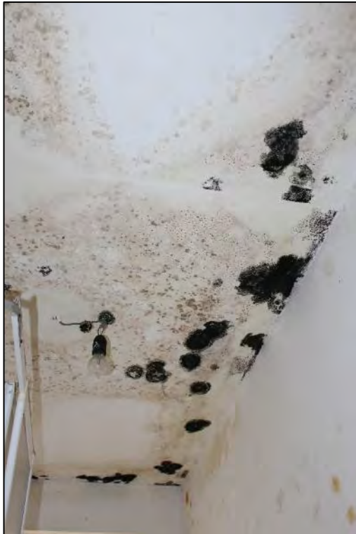
Foto Nr. 93: 3. OG rechts, ETW Nr. 7, Bad / Feuchteschäden
