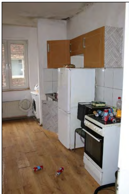
Foto Nr. 40: 1. OG rechts, ETW Nr. 1, Küche / Feuchteschäden
