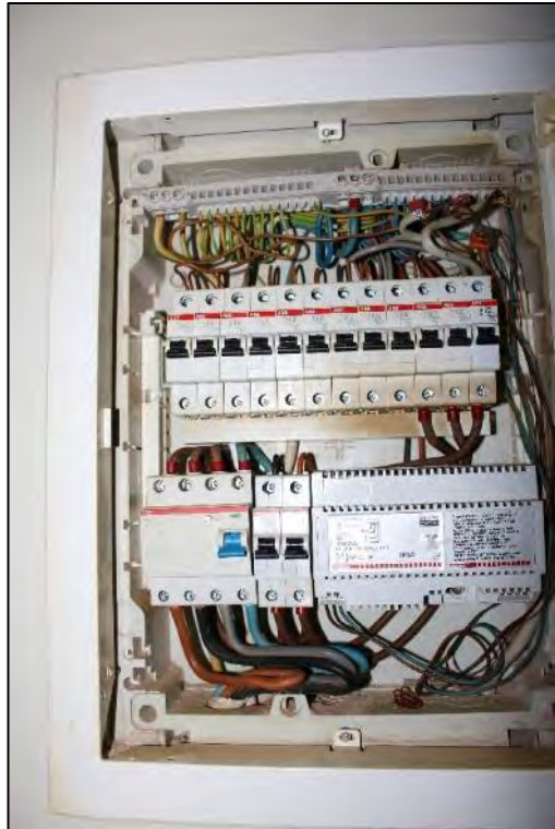
Foto Nr. 27: Teileigentum Nr. 13, Eingang Königsberger Straße 36 b, Elektrounterverteilung
