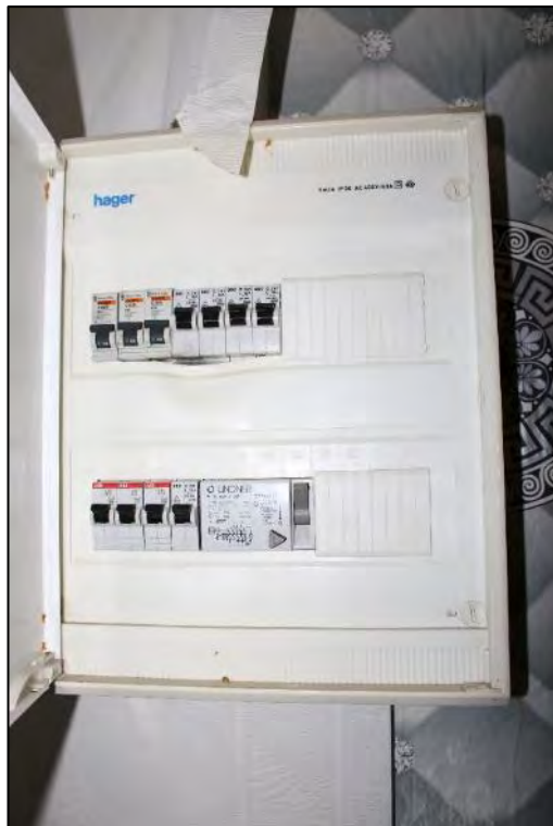
Foto Nr. 66: 2. OG mittig, ETW Nr. 5, Elektrounterverteilung
