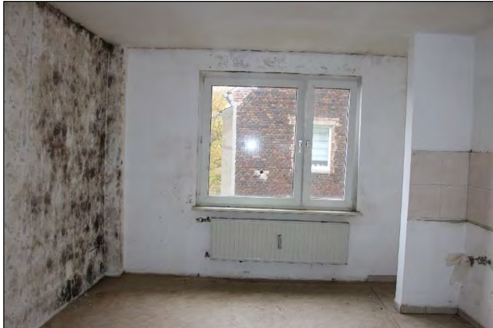
Foto Nr. 87: 3. OG rechts, ETW Nr. 7, Küche / Feuchteschäden
