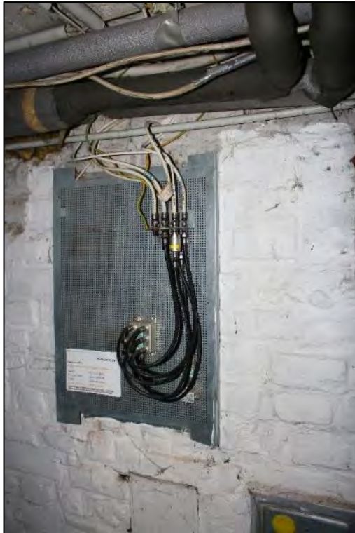
Foto Nr. 17: Kellergeschoss, Kabelanschluss
