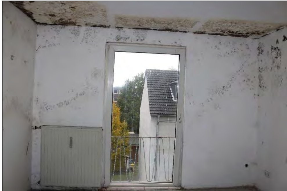
Foto Nr. 91: 3. OG rechts, ETW Nr. 7, Wohnzimmer / Feuchteschäden
