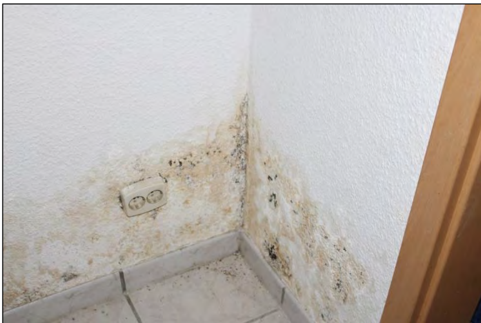
Foto Nr.116: DG rechts, ETW Nr. 10, Schlafzimmer / Feuchteschäden
