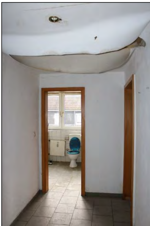
Foto Nr. 122: DG mittig, ETW Nr. 11, Diele / Feuchteschäden Decke
