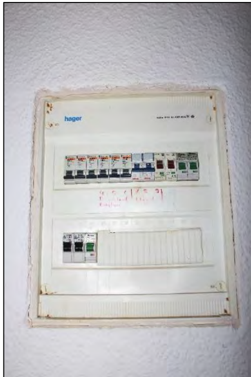
Foto Nr. 111: DG rechts, ETW Nr. 10, Elektrounterverteilung
