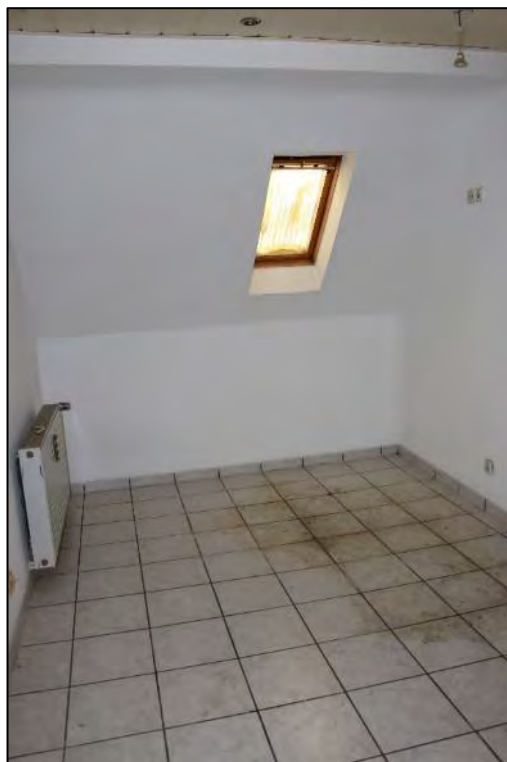
Foto Nr. 112: DG rechts, ETW Nr. 10, Küche
