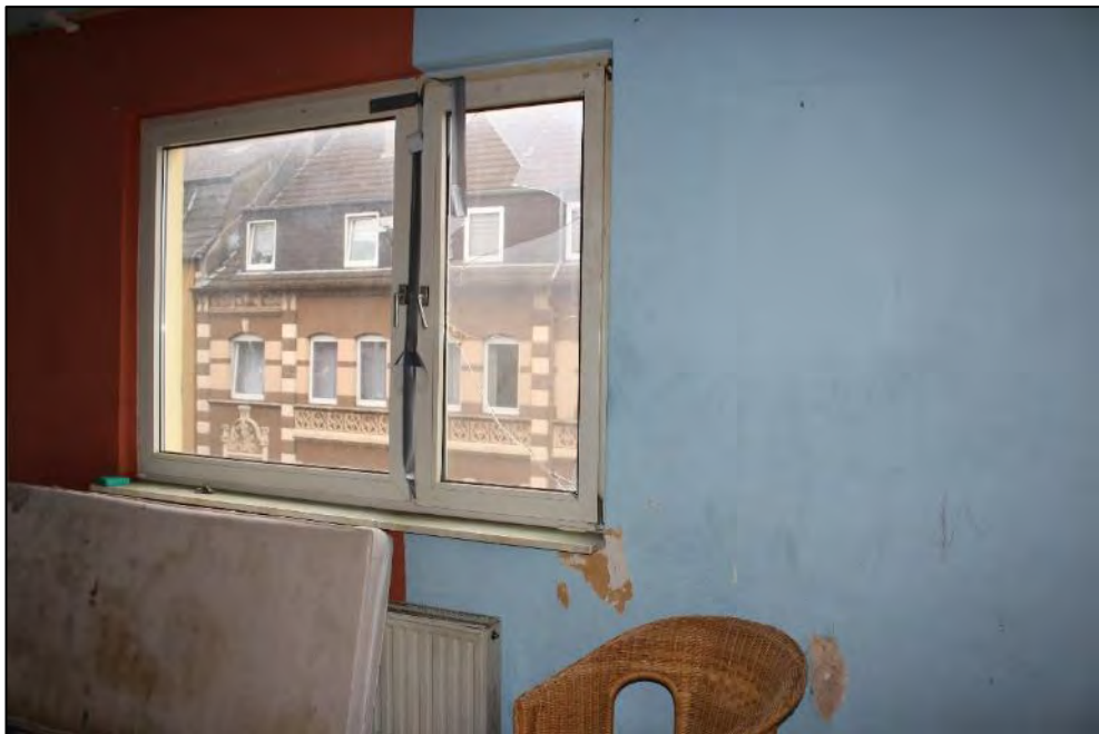
Foto Nr. 100: 3. OG mittig, ETW Nr. 8, Schlafen / Fenster defekt
