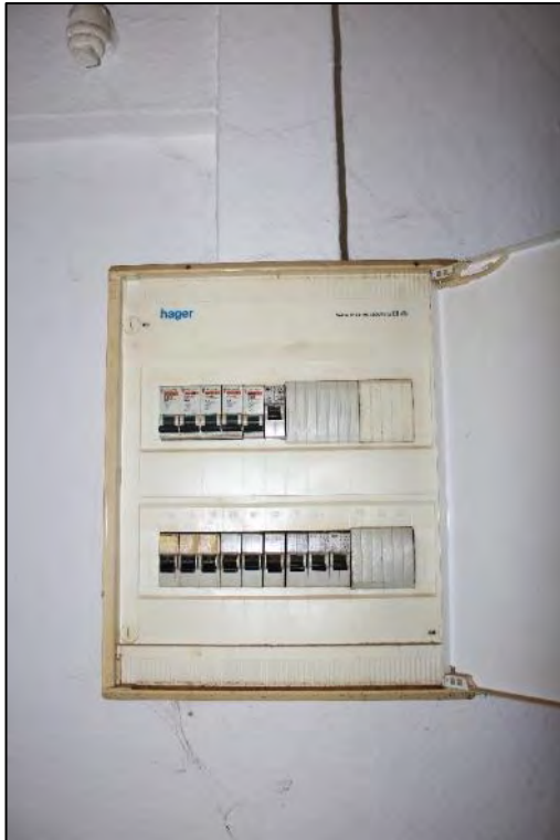
Foto Nr. 121: DG mittig, ETW Nr. 11, Elektrounterverteilung
