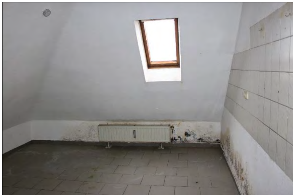
Foto Nr. 126: DG mittig, ETW Nr. 11, Küche / Feuchteschäden
