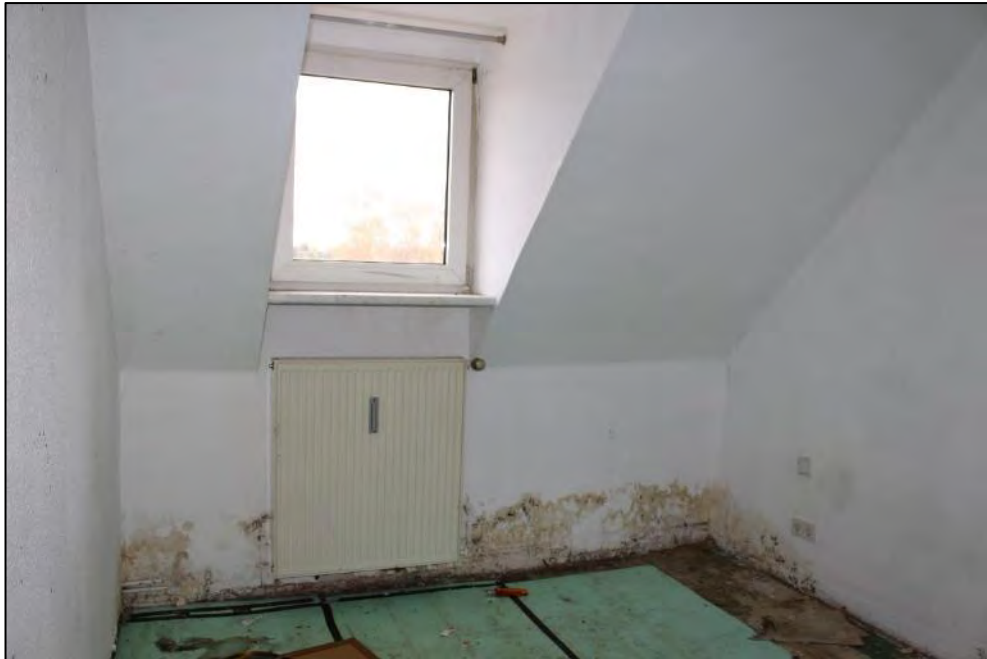
Foto Nr. 115: DG rechts, ETW Nr. 10, Schlafzimmer / Feuchteschäden
