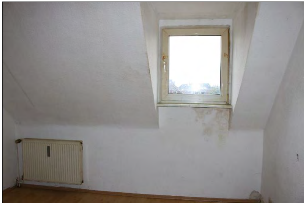
Foto Nr. 125: DG mittig, ETW Nr. 11, Wohnzimmer / Feuchteschäden
