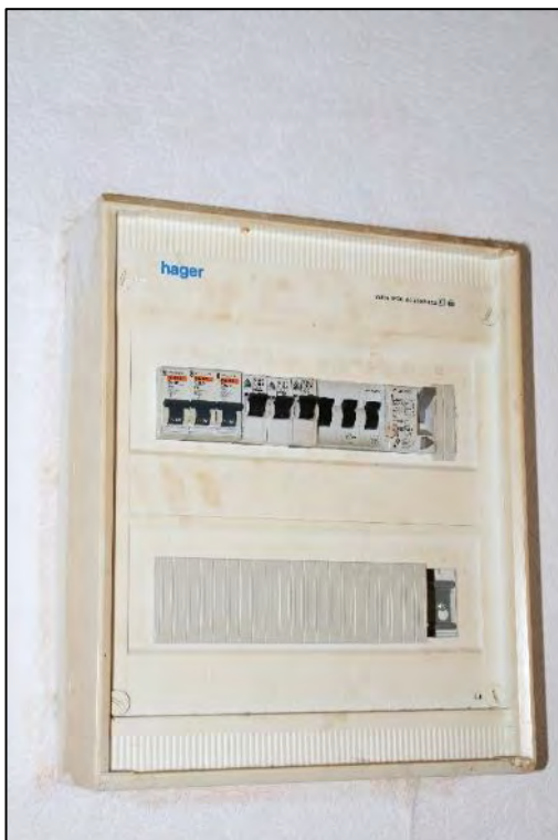
Foto Nr. 104: 3. OG links, ETW Nr. 9, Elektrounterverteilung
