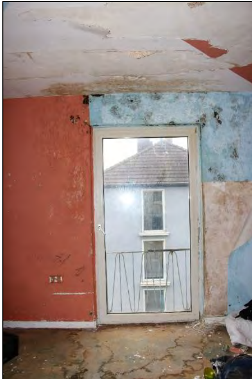
Foto Nr. 99: 3. OG mittig, ETW Nr. 8, Wohnzimmer / Feuchteschäden
