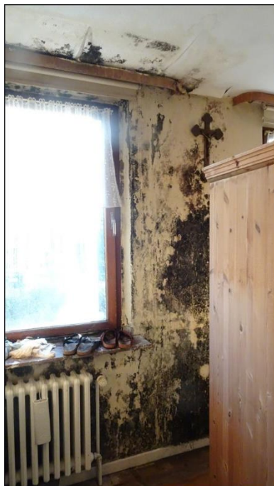
19) Erdgeschoss/ Schimmel an der Außenwand
