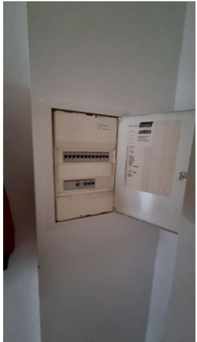
WE 4.2; Elektrounterverteilung im Flur mit Sicherungsautomaten.
