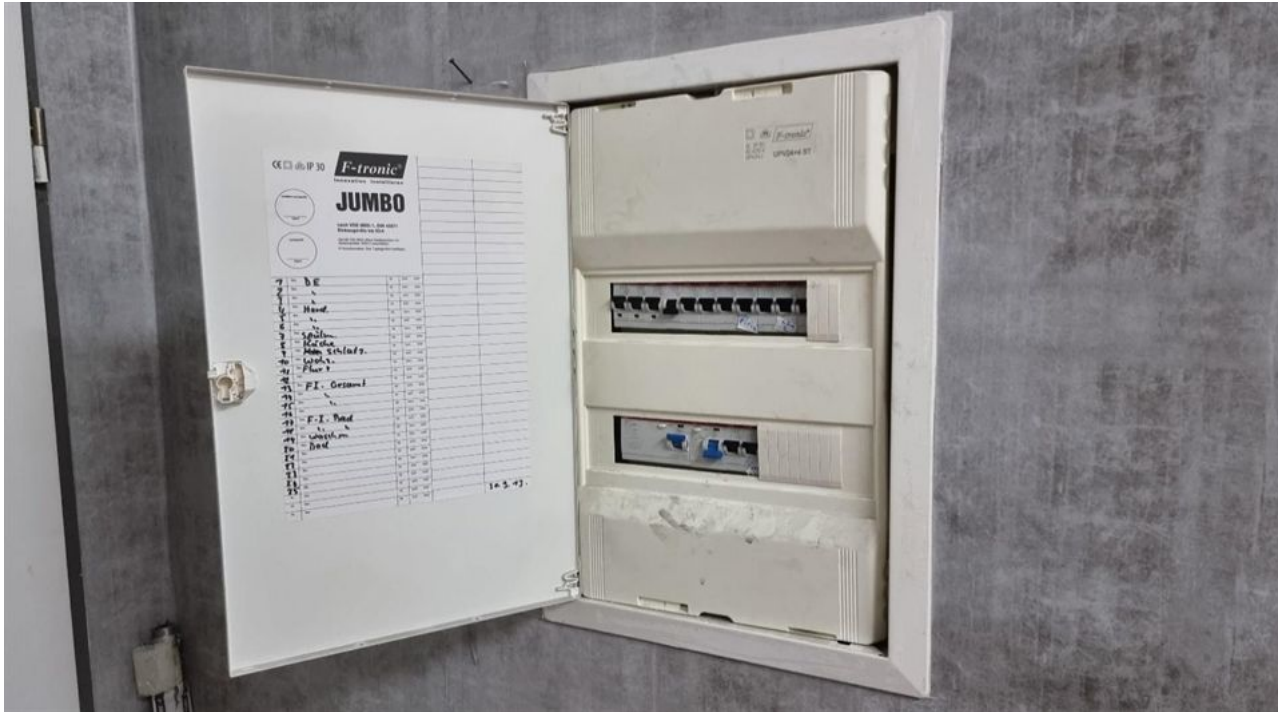
WE 4.1; Elektro-Unterverteilung in der Diele mit Sicherungsautomaten.
