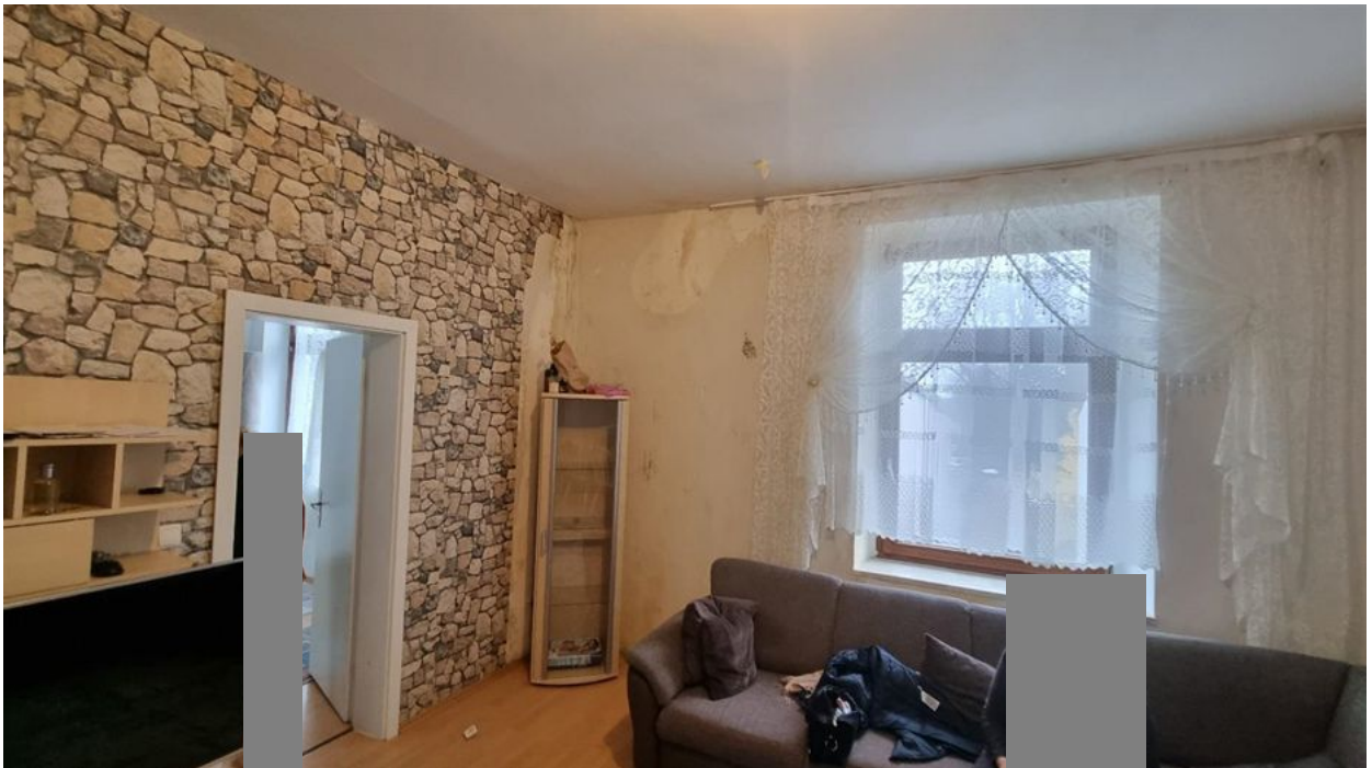
WE 4.1; Straßenseitiges Durchgangszimmer mit Feuchtigkeitsschaden an Wand und Decke.
