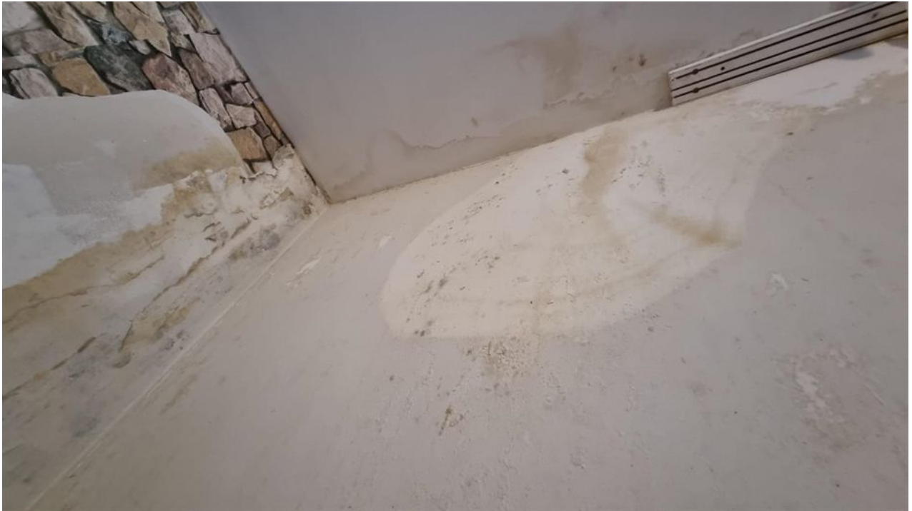
WE 4.1; Feuchtigkeitsschäden an der Wand- und Deckenfläche.
