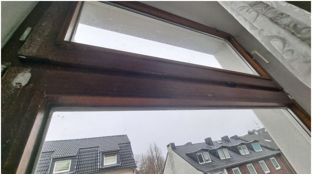
WE 4.1; Abgenutzte Holzfenster mit Isolierverglasung älteren Baujahres.
