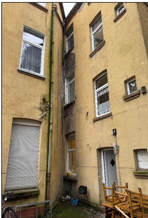
Foto Nr. 4: Hoffassade / Schäden
