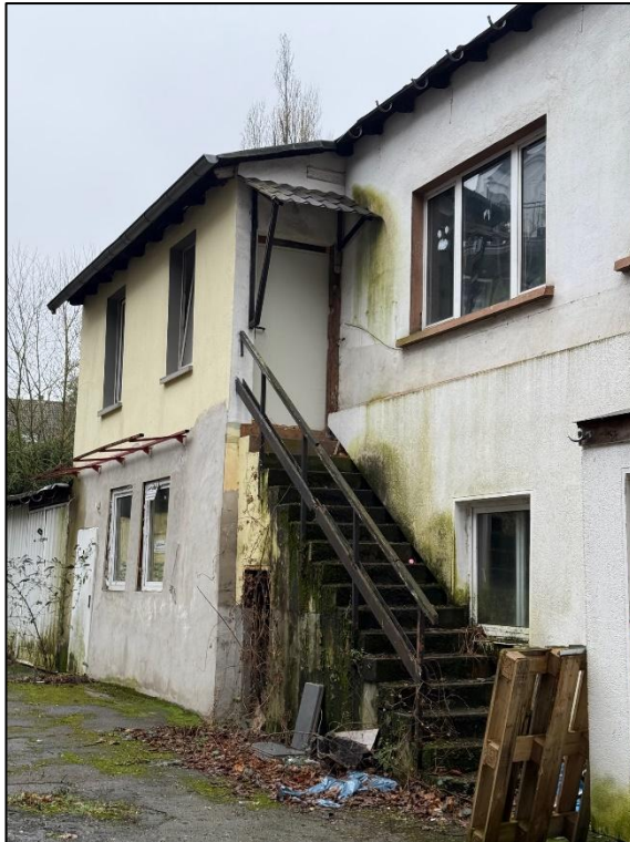
Foto Nr. 9: Nebengebäude / Schäden
