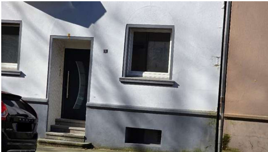
Hauseingangsbereich und Verschmutzung der Fassade im Sockelbereich.
