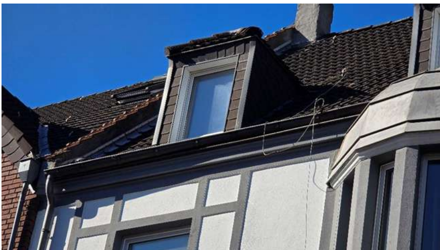
Unbefestigte Kabel vor der Fassade.
