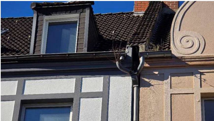
Vom Regenfallrohr abgelöste Dachrinne.
