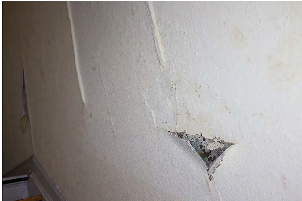
Foto Nr. 65: Gemeinschaftstreppe, Dachgeschoss / Feuchteschäden
