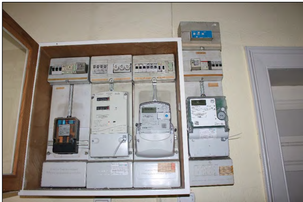
Foto Nr. 66: Gemeinschaftstreppe, Dachgeschoss / Elektrounterverteilung
