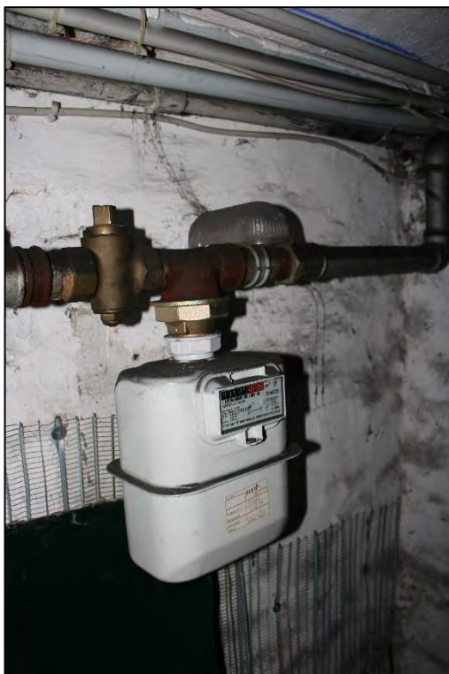
Foto Nr. 22: Kellergeschoss, Gaszähler
