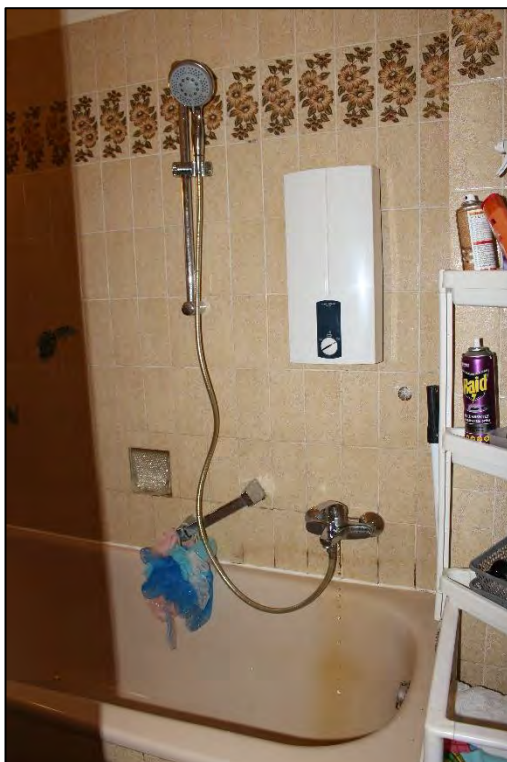
Foto Nr. 40: 1. OG links, WE Nr. 2, Bad
