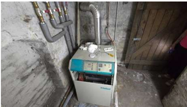
Zentraler Gas-Heizkessel (WE 2 bis 7).
