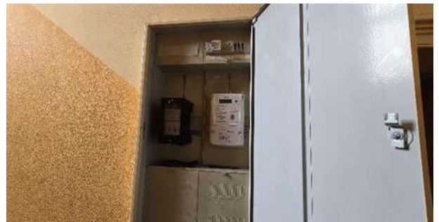
Treppenhaus im EG, Zählerschrank.
