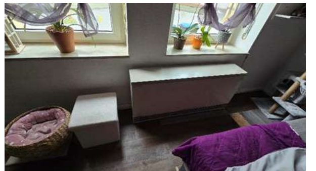
WE 1, EG rechts; Nachtspeicheröfen in Wohnküche und Zimmer vorne rechts.
