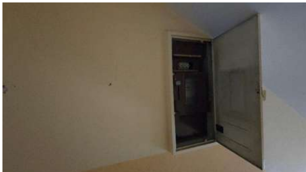
Treppenhaus im DG; Stromzähler zu WE 7.
