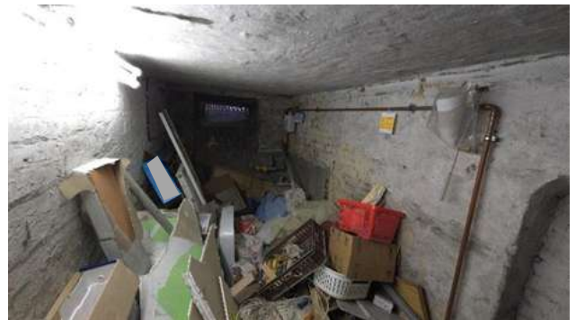
Kellerraum vorne mit Gaszähler.
