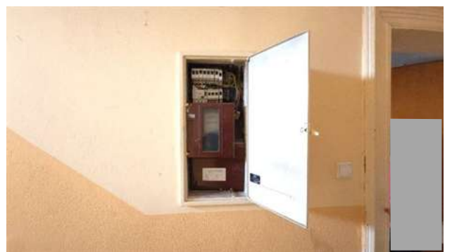
Treppenhaus im 2.OG, Zählerschrank zu WE 5.
