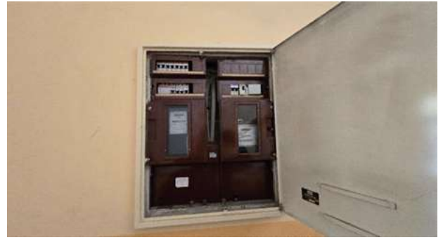
Treppenhaus, EG; Zählerschrank zu WE 2 und Allgemeinstrom.
