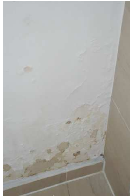
Bild 16: Feuchtigkeit im Badezimmer
