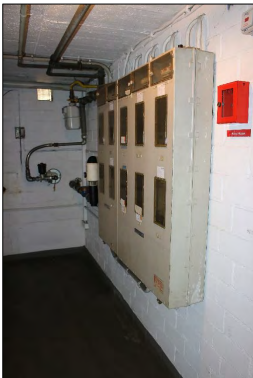
Foto Nr. 32: Bochumer Straße 129, Kellergeschoss, Elektrounterverteilung
