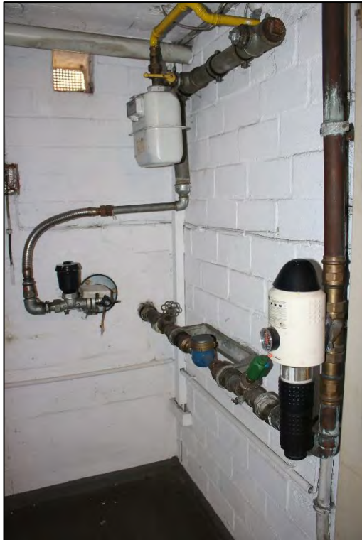
Foto Nr. 31: Bochumer Straße 129, Kellergeschoss, Hausanschlüsse
