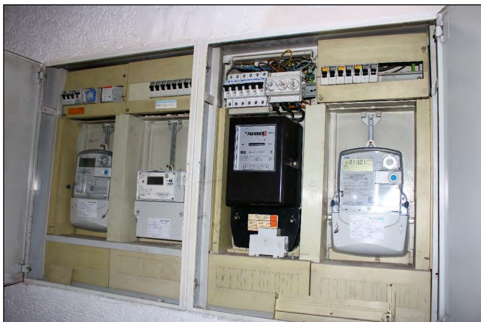
Foto Nr. 10: Gemeinschaftstreppe, Erdgeschoss, Elektrounterverteilung
