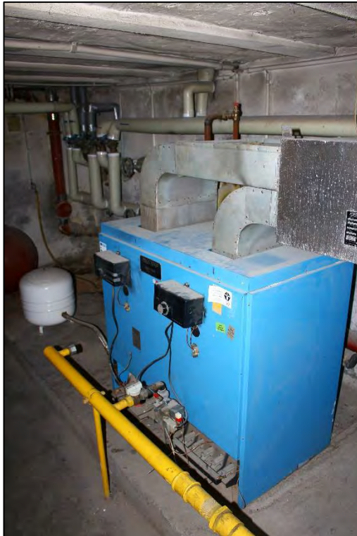
Foto Nr. 15: Kellergeschoss, Heizungsraum
