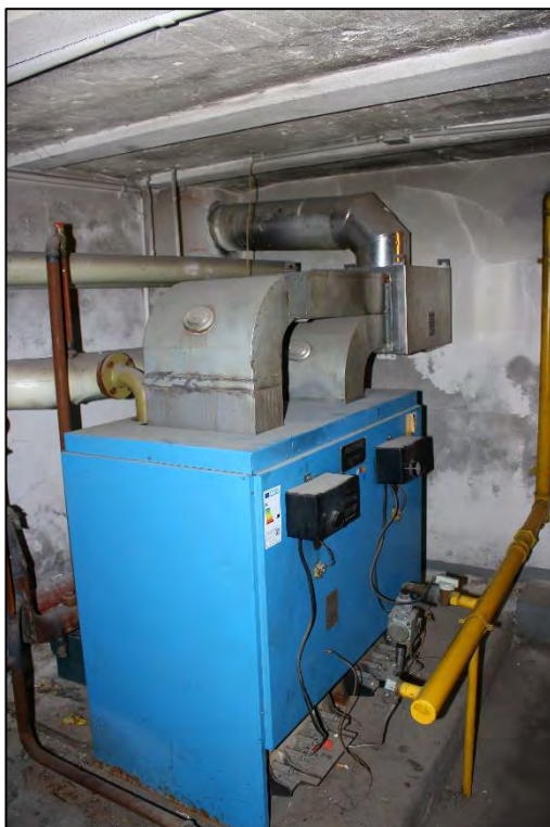
Foto Nr. 16: Kellergeschoss, Heizungsraum
