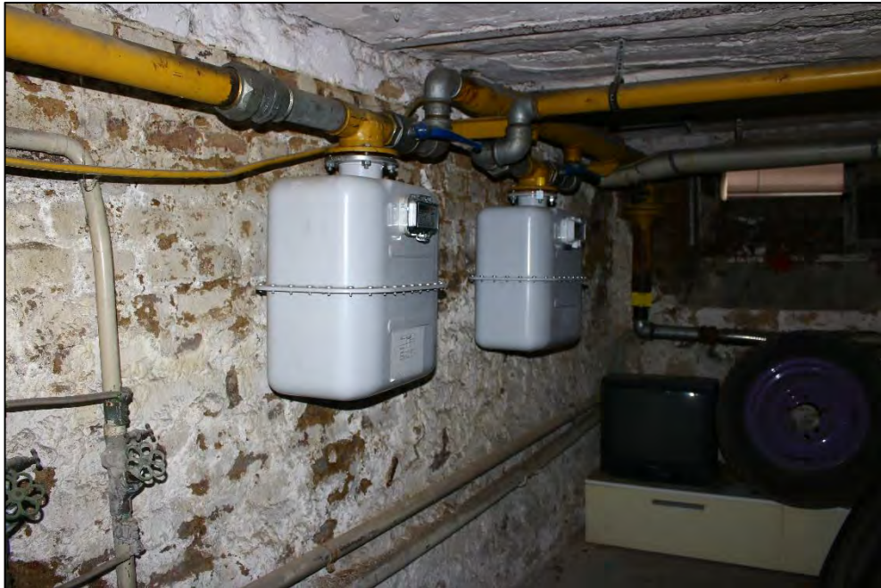
Foto Nr. 17: Kellergeschoss, Hausanschlüsse / Gaszähler
