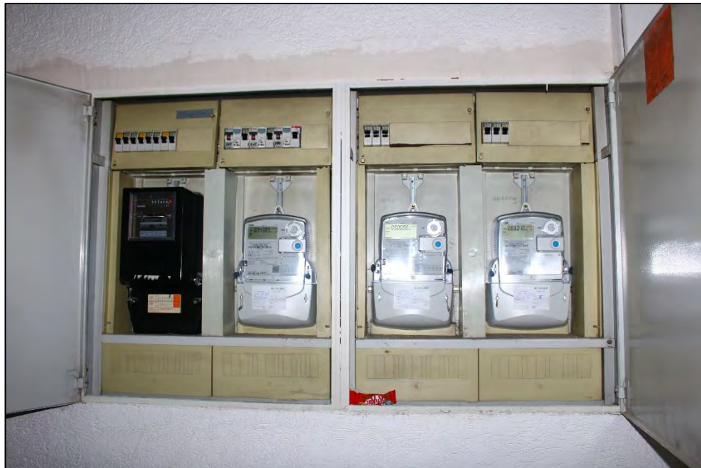
Foto Nr. 9: Gemeinschaftstreppe, Erdgeschoss, Elektrounterverteilung
