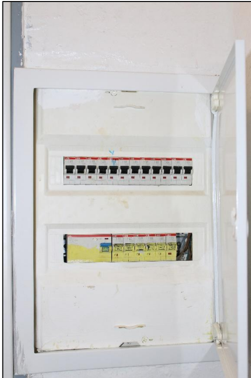
Foto Nr. 17: 1. OG links, ETW Nr. 4, Flur / Elektrounterverteilung
