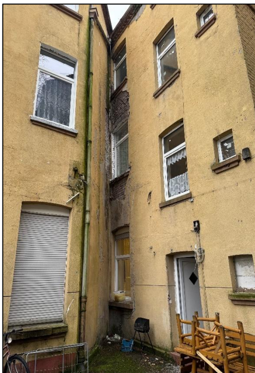
Foto Nr. 4: Hoffassade / Schäden
