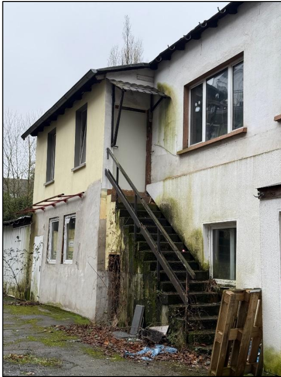
Foto Nr. 9: Nebengebäude / Schäden
