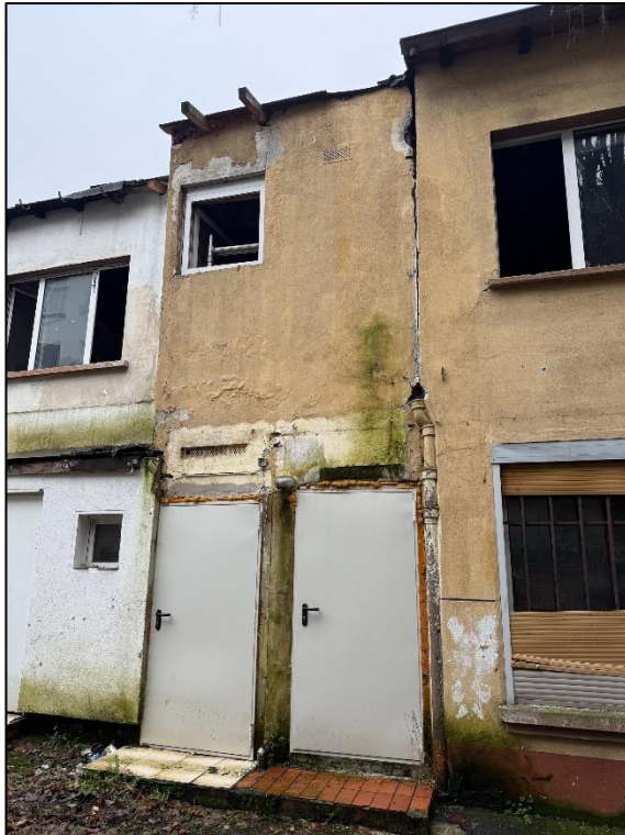
Foto Nr. 11: Nebengebäude / Schäden
