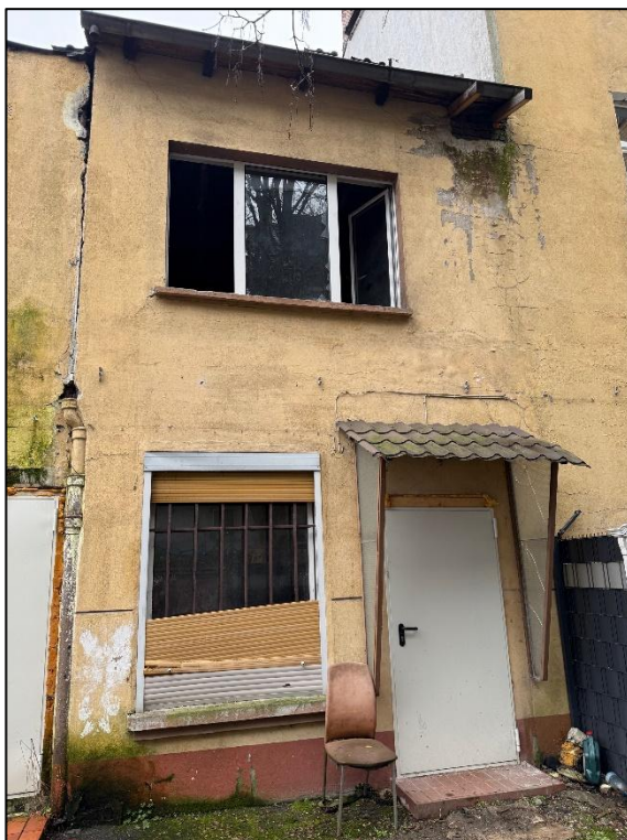
Foto Nr. 10: Nebengebäude / Schäden
