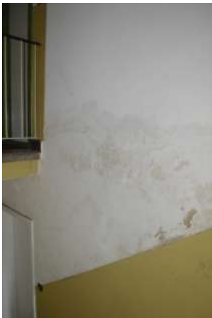
Bild 11: Bsp. Feuchtigkeitsschäden Treppenhauswand
