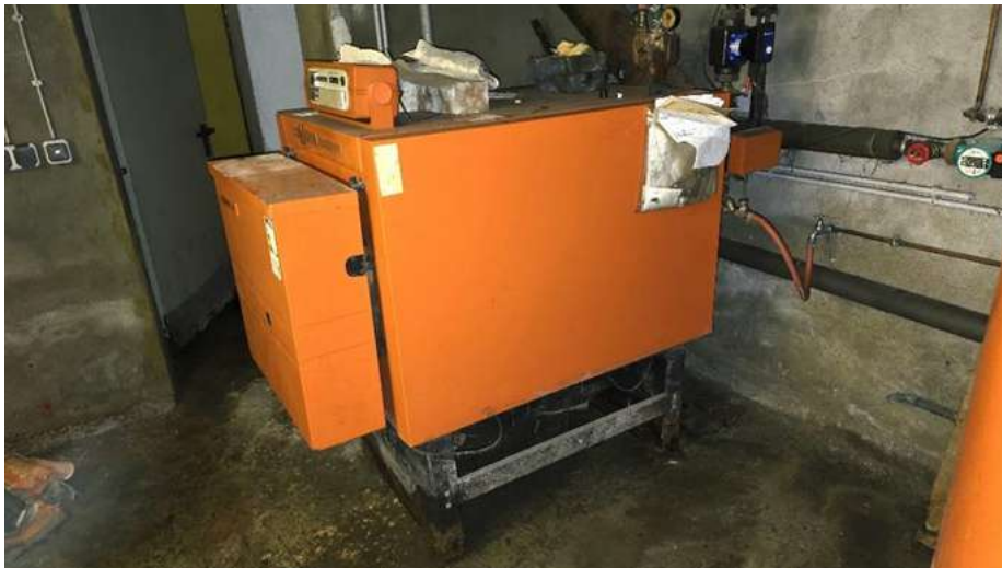
KG; Heizungskellerraum mit mutmaßlich funktionsuntüchtigem zentralem Heizkessel.
