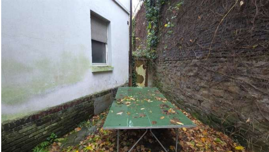
Darstellung der Nähe zwischen Wohnhaus und Stützmauer im hinteren Grundstücksbereich.
