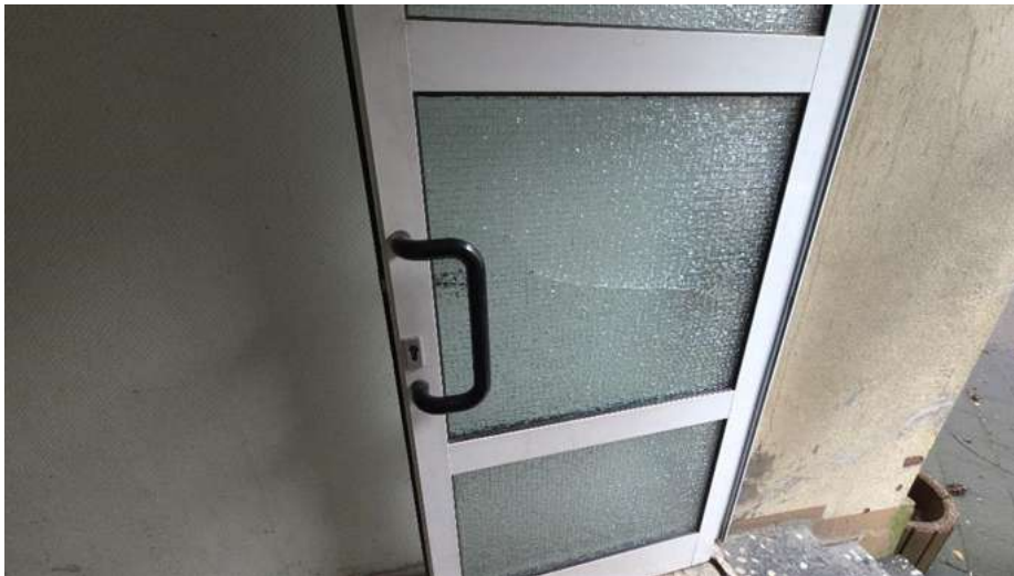
Hauseingangstür mit beschädigtem Glaseinsatz.
