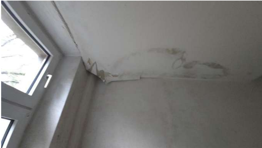
Treppenhaus, Zwischenpodest EG / OG. Mutmaßlich Feuchtigkeitsschaden im Wand- / Deckenbereich.
