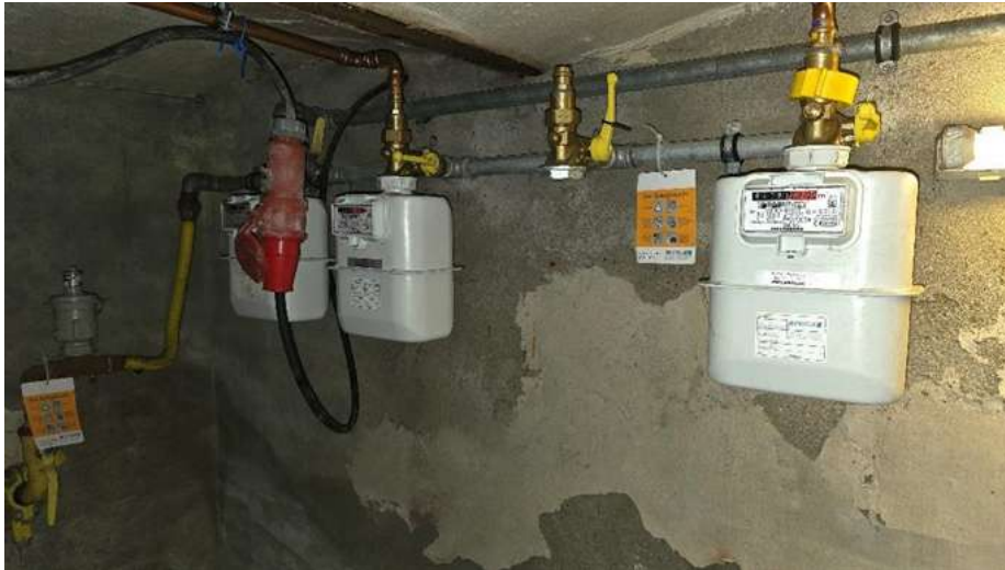
KG; Gasanschluss des Wohnhauses mit Zählern.
