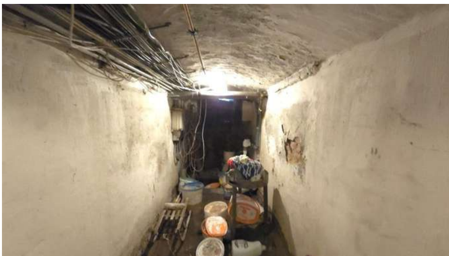
Vermüllter Kellerflur mit Ausblühungen im Wand- und Deckenbereich sowie unkoordinierter Elektroinstallation.
