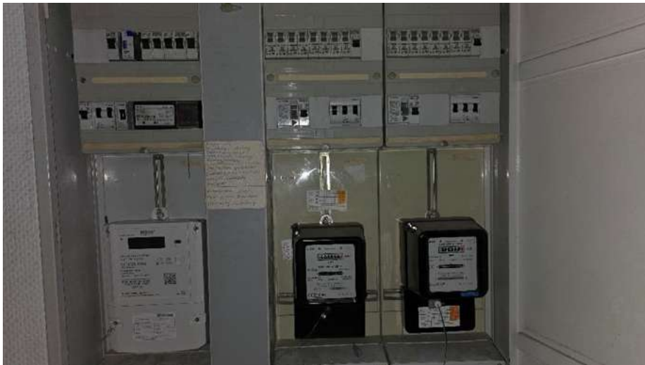
Treppenhaus, Zählerschrank mit Sicherungsautomaten im EG.
