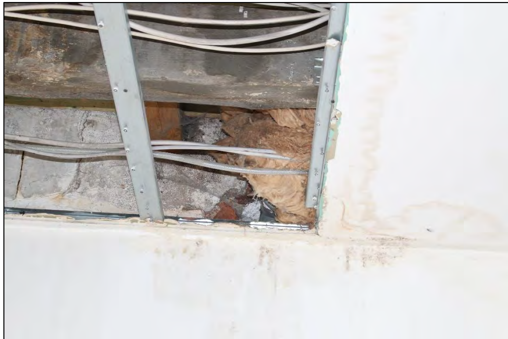
Foto Nr. 59: Werkstattgebäude, Werkstatt, Feuchteschäden Decke
