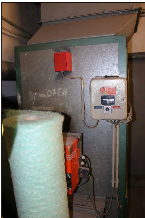
Foto Nr. 62: Werkstattgebäude, Heizungsraum
