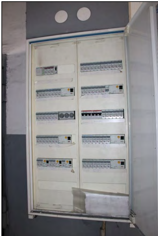
Foto Nr. 61: Werkstattgebäude, Elektrounterverteilung
