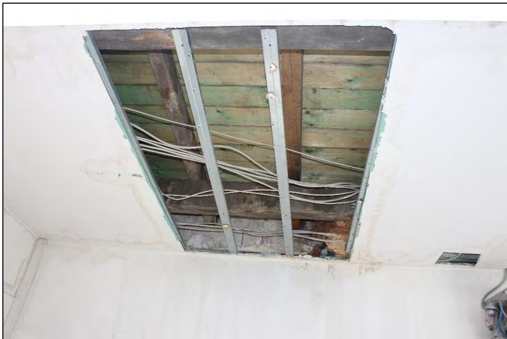
Foto Nr. 58: Werkstattgebäude, Werkstatt Feuchteschäden Decke
