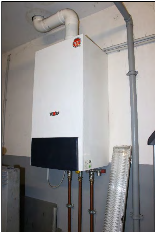
Foto Nr. 63: Werkstattgebäude, Heizungsraum
