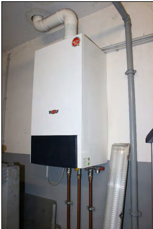
Foto Nr. 63: Werkstattgebäude, Heizungsraum
