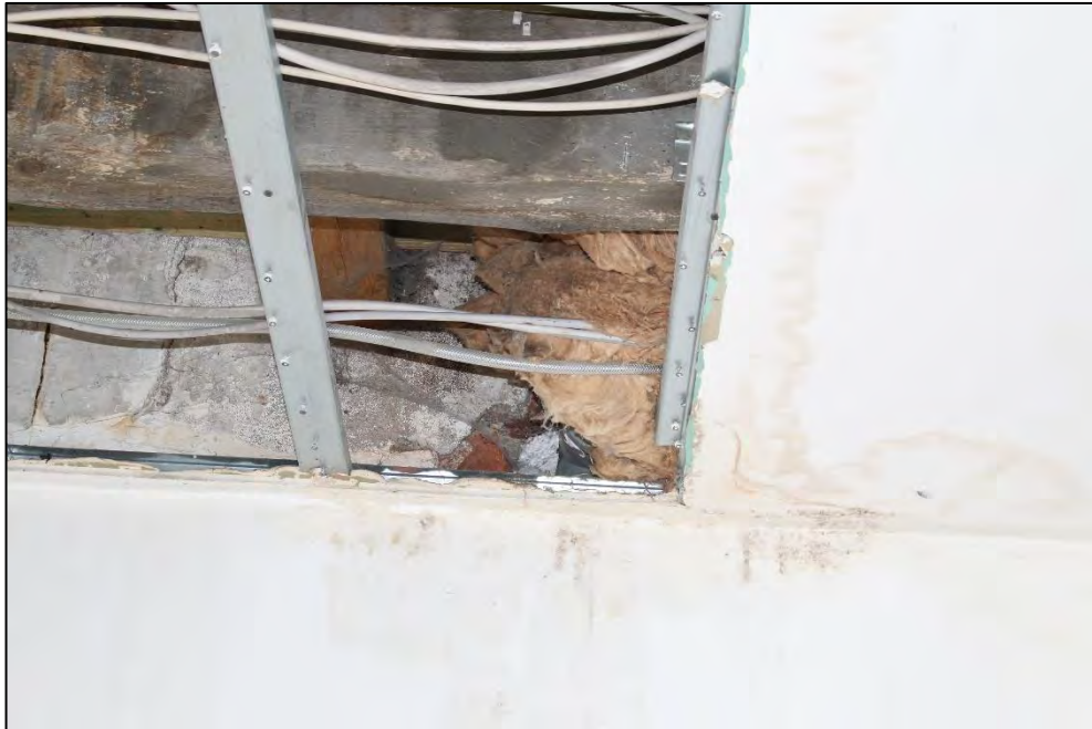
Foto Nr. 59: Werkstattgebäude, Werkstatt, Feuchteschäden Decke
