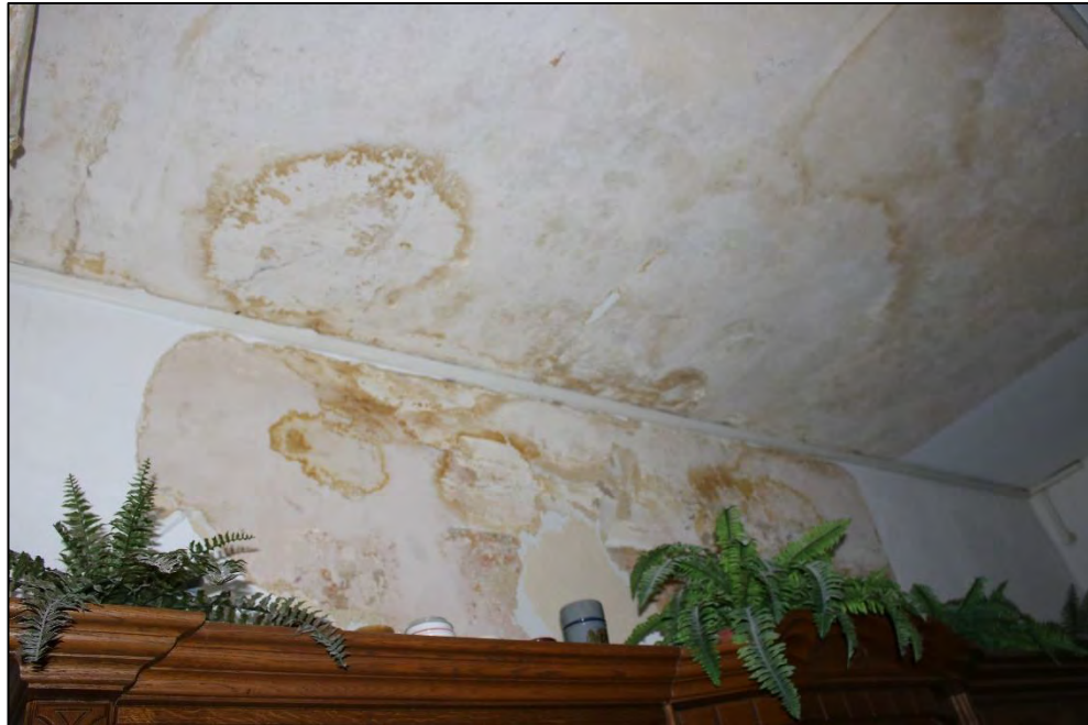
Foto Nr. 47: 3. OG, WE Nr. 4, Feuchteschäden Arbeitszimmer 2
