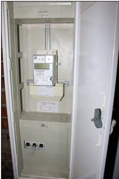
Foto Nr. 13: Kellergeschoss, Elektrounterverteilung
