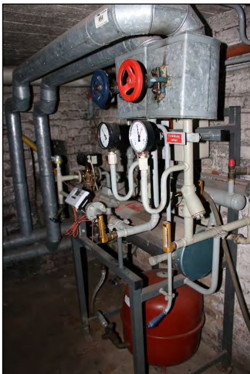
Foto Nr. 14: Kellergeschoss, Fernwärmeheizungsanlage
