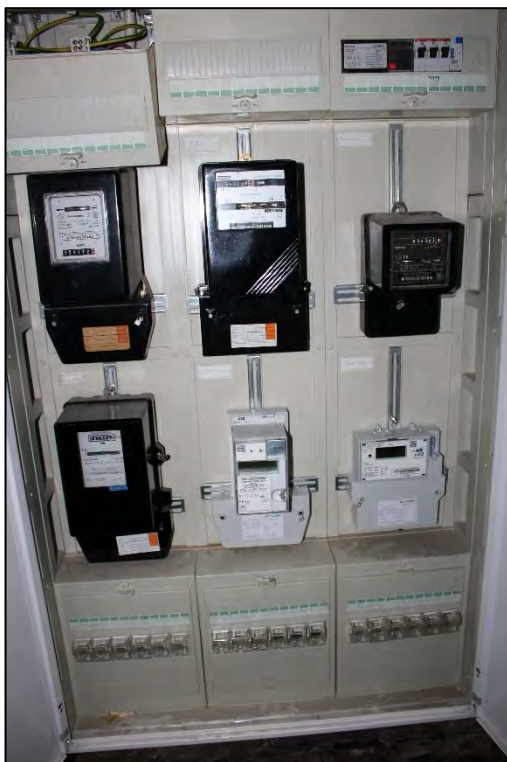
Foto Nr. 12: Kellergeschoss, Elektrounterverteilung
