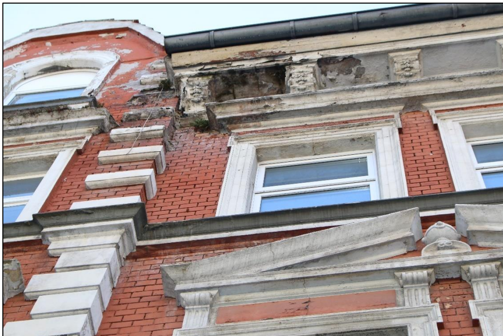
Foto Nr. 4: Schäden Dachanschluss, Wiehagen 35
