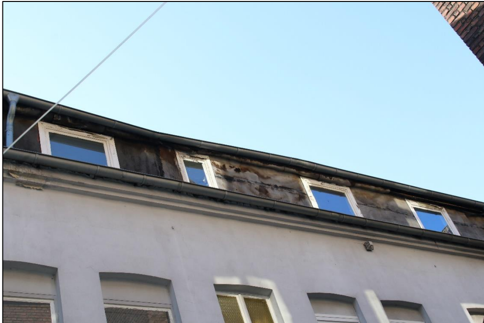
Foto Nr. 15: Schäden Dachgaube, Wiehagen 35a
