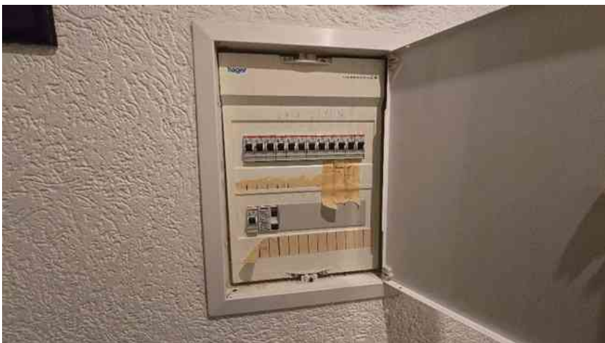
Elektronterverteilung mit Sicherungsautomaten in der Diele.
