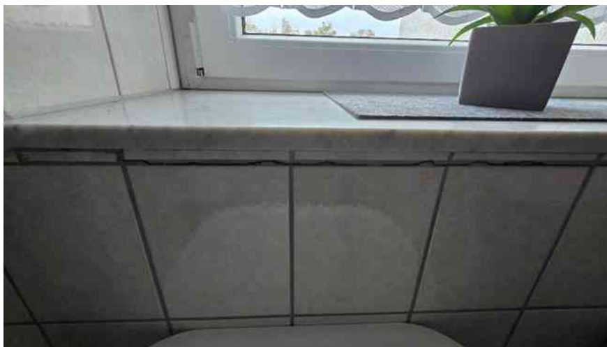
Risse im Fugennetz.
