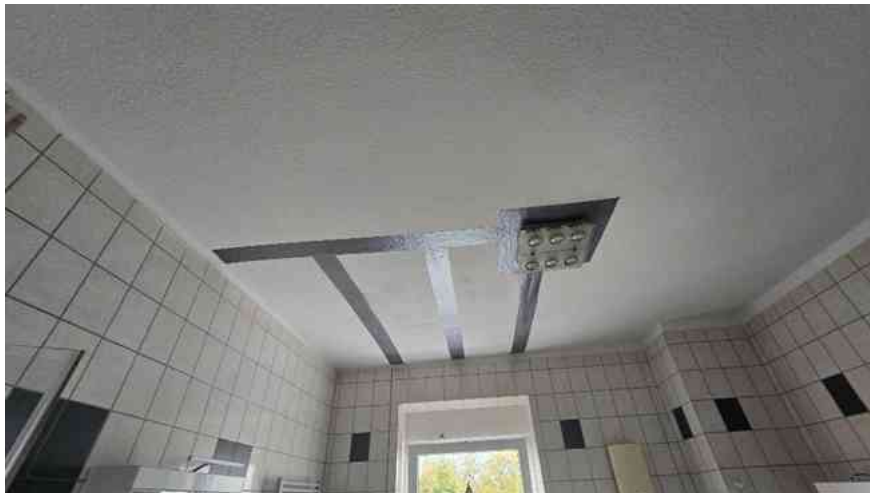
Notdürftig reparierter Feuchtigkeitsschaden unter der Decke.
