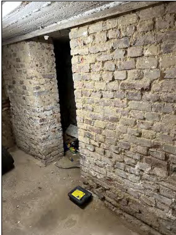
Foto Nr. 15: Kellergeschoss, Kellerraum / Müllablagerungen
