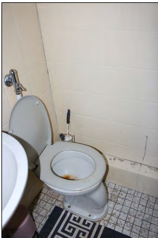
Foto Nr. 36: Dachgeschoss, ETW Nr. 7, Bad
