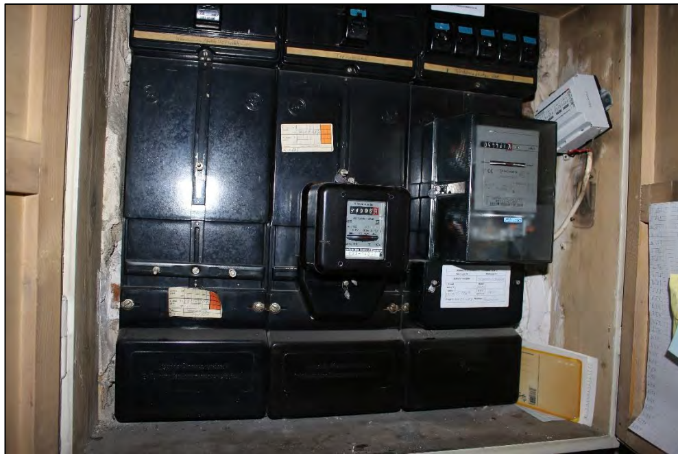
Foto Nr. 23: Gemeinschaftstreppe, Dachgeschoss, Stromzähler
