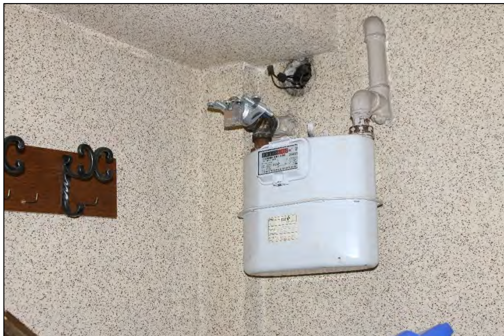
Foto Nr. 24: Gemeinschaftstreppe Dachgeschoss, Gaszähler
