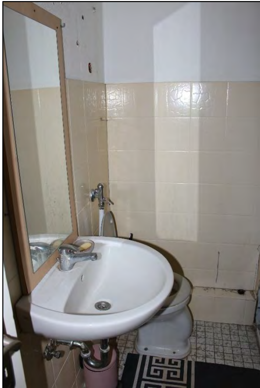
Foto Nr. 37: Dachgeschoss, ETW Nr. 7, Bad
