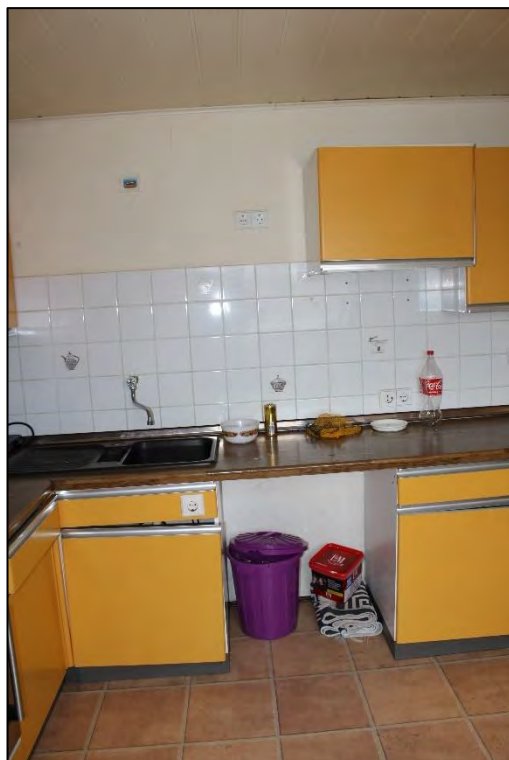
Foto Nr. 34: Dachgeschoss, ETW Nr. 7, Küche
