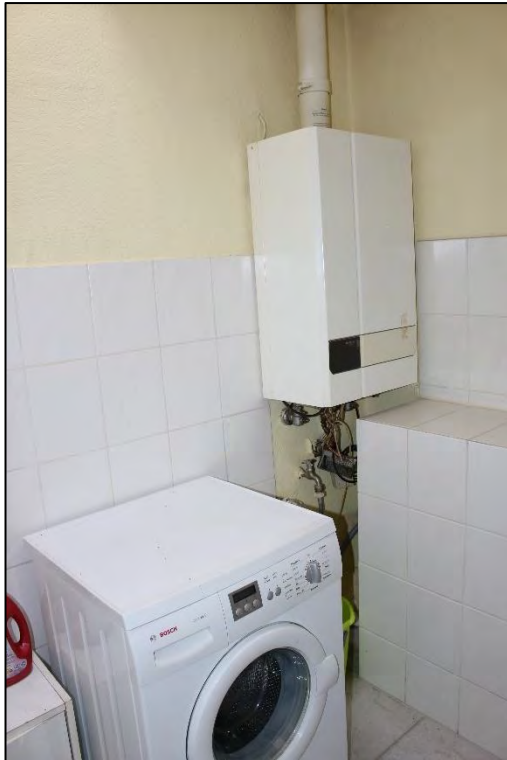
Foto Nr. 29: Dachgeschoss, ETW Nr. 7, WC / Heizungsanlage
