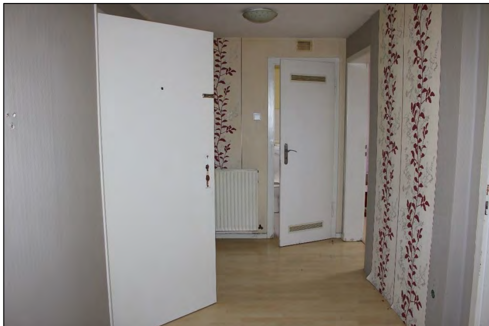
Foto Nr. 26: Dachgeschoss, ETW Nr. 7, Diele
