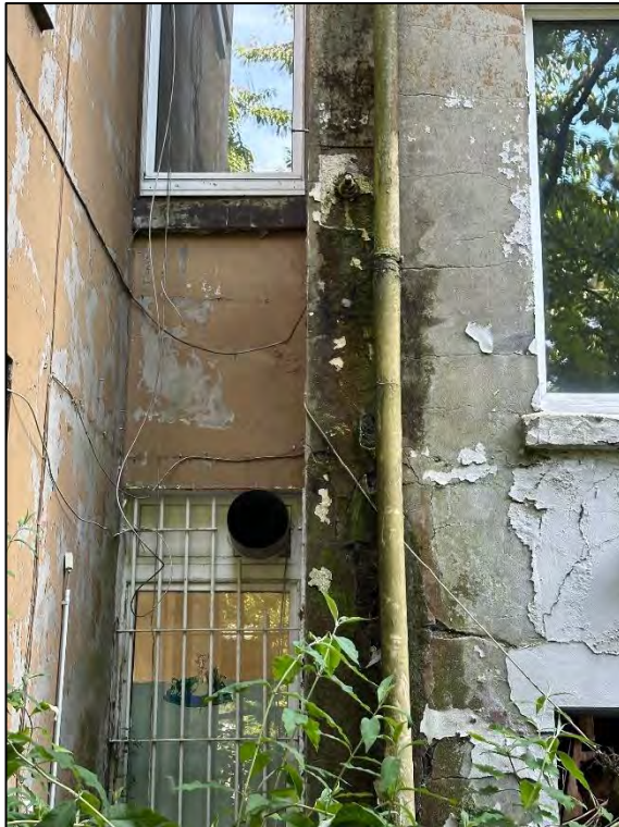
Foto Nr. 13: Gartenfassade / Schäden
