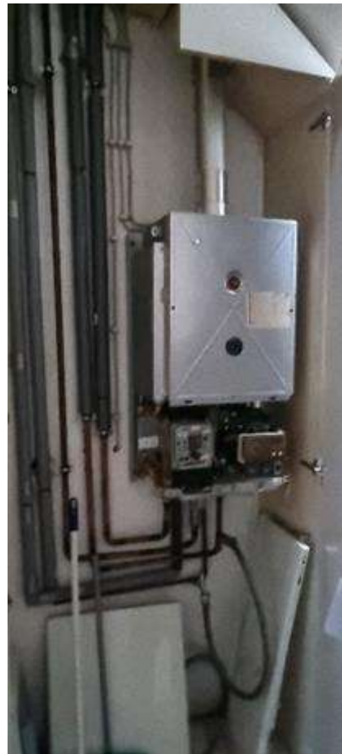
Gas-Therme (Heizung und Warmwasser)
