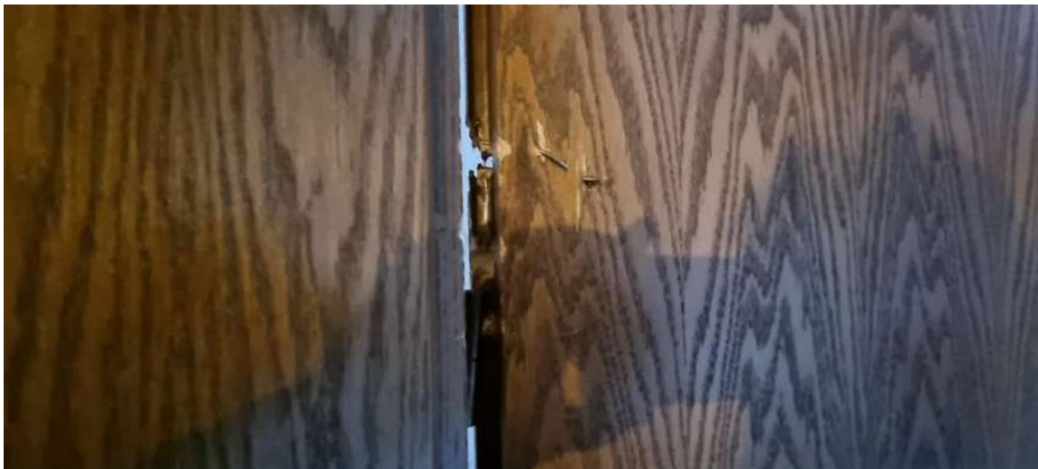
Beispiel für Schäden an Türen.
