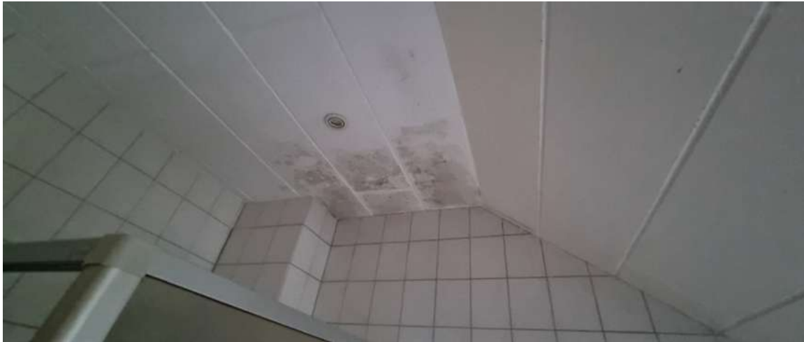
Schimmel unter der Decke des Bad/WC.
