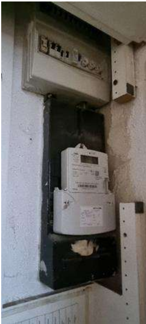
Zählertafel mit Elektro-Unterverteilung.
