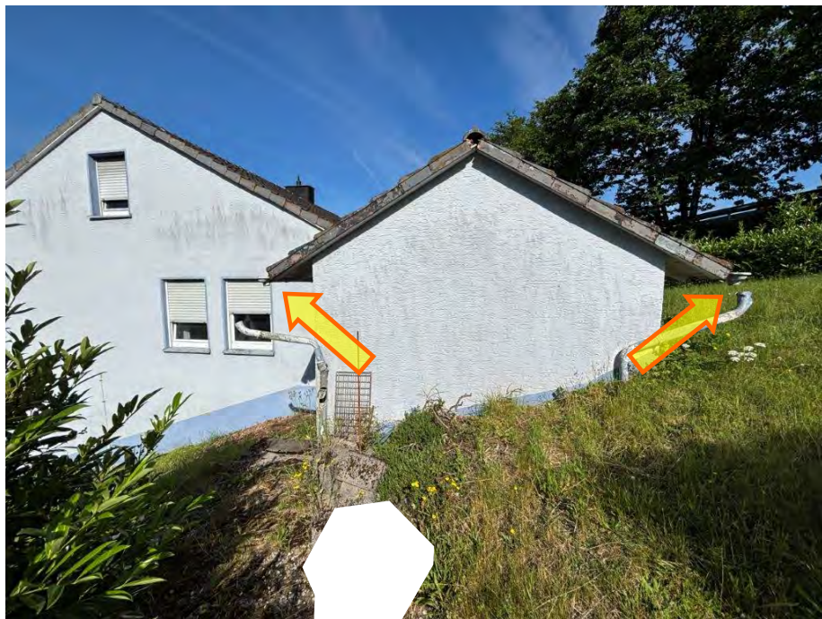
Garage – Schäden an der Dachrinne
