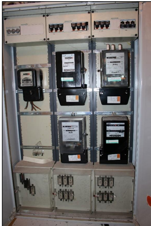
Foto Nr. 9: Kellergeschoss, Elektrounterverteilung
