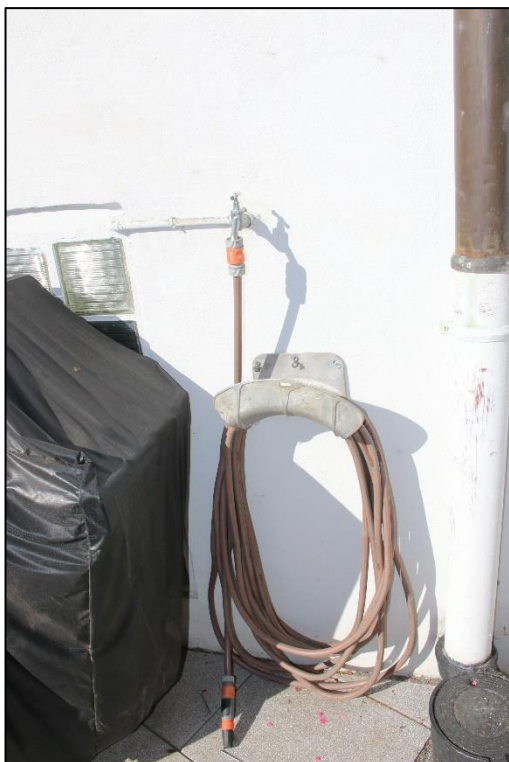
Foto Nr. 6: Außenwasseranschluss
