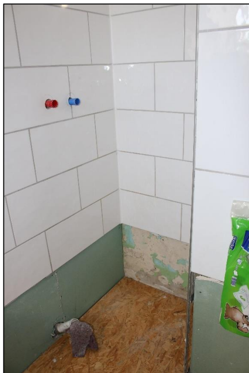
Foto Nr. 26: Dachgeschoss, ETW Nr. 4, Bad
