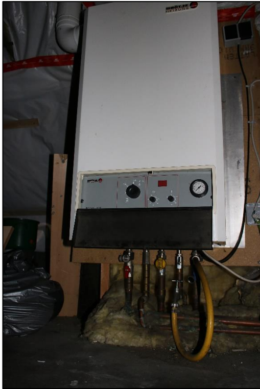
Foto Nr. 35: Dachboden, ETW Nr. 4, Heizungsanlage
