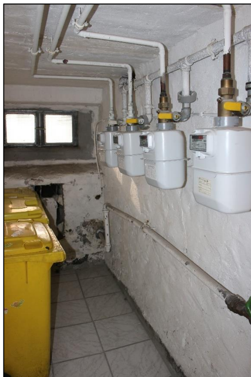
Foto Nr. 14: Kellergeschoss, Gaszähler
