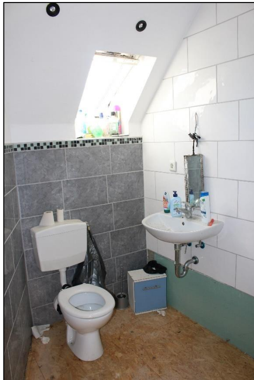
Foto Nr. 25: Dachgeschoss, ETW Nr. 4, Bad
