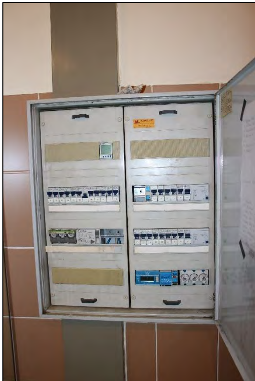
Foto Nr. 31: Teileigentum Nr. B 3, EG, Overwegstraße 32, Vorflur WC / Elektrounterverteilung
