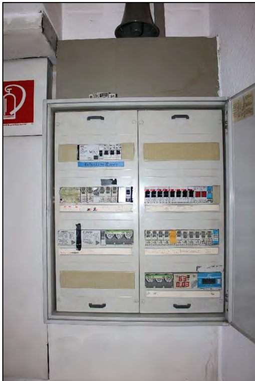
Foto Nr. 39: Teileigentum B 3, KG, Overwegstraße 32, Elektrounterverteilung
