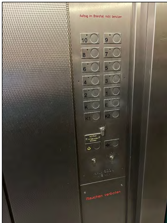
Foto Nr. 9: Gemeinschaftstreppenhaus, Overwegstraße 32, Aufzugsanlage
