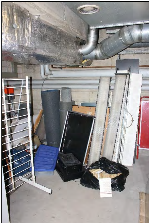
Foto Nr. 47: Teileigentum B 3, KG, Overwegstraße 32, Technikraum
