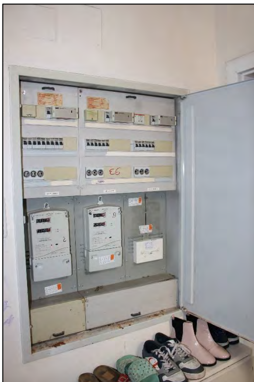
Foto Nr. 20: Dresdener Straße 28, Gemeinschaftstreppe, Elektrounterverteilung
