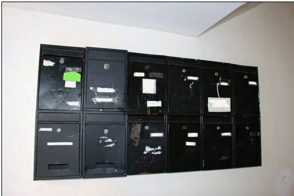
Foto Nr. 8: Dresdener Straße 28, Gemeinschaftstreppehaus, Briefkastenanlage
