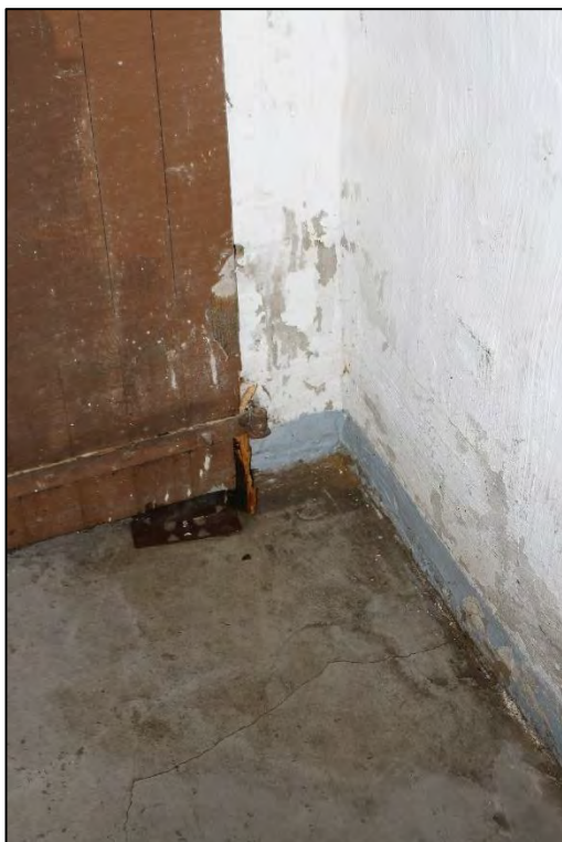
Foto Nr. 16: Dresdener Straße 28, Kellergeschoss, Flur / Wasser
