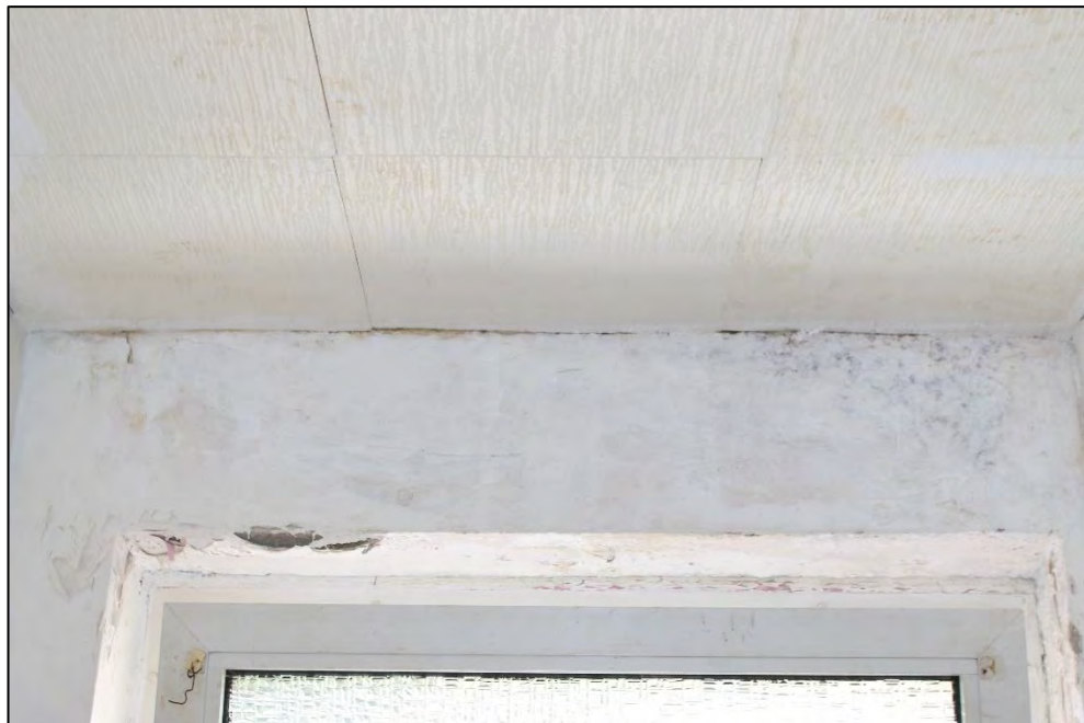
Foto Nr. 42: Dresdener Straße 28, ETW Nr. 14, 1. OG links, Bad / Feuchteschäden
