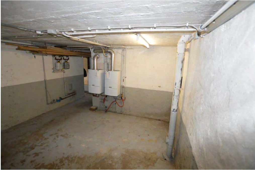
Heizungskeller mit 2 Gasthermen
