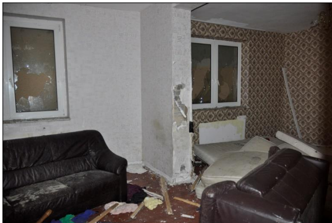
7) Wohnungen Erdgeschoss/ nicht genehmigter Durchbruch
