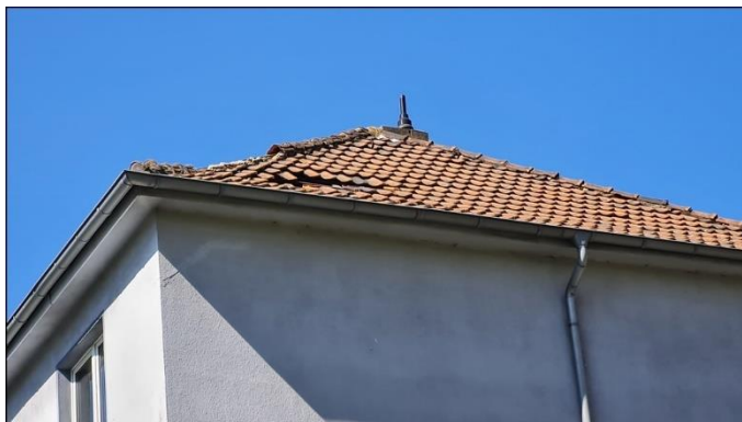
4) Detailfoto/ Schäden Dacheindeckung Haus Nr. 127
