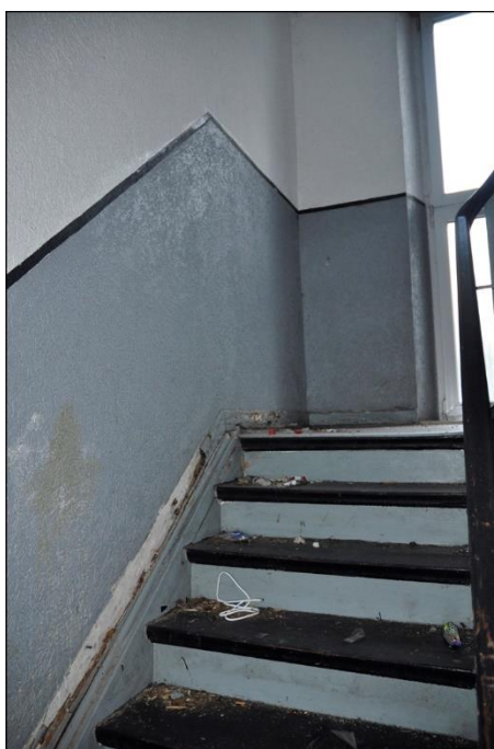
15) Treppenhaus/ Schäden an der Treppe
