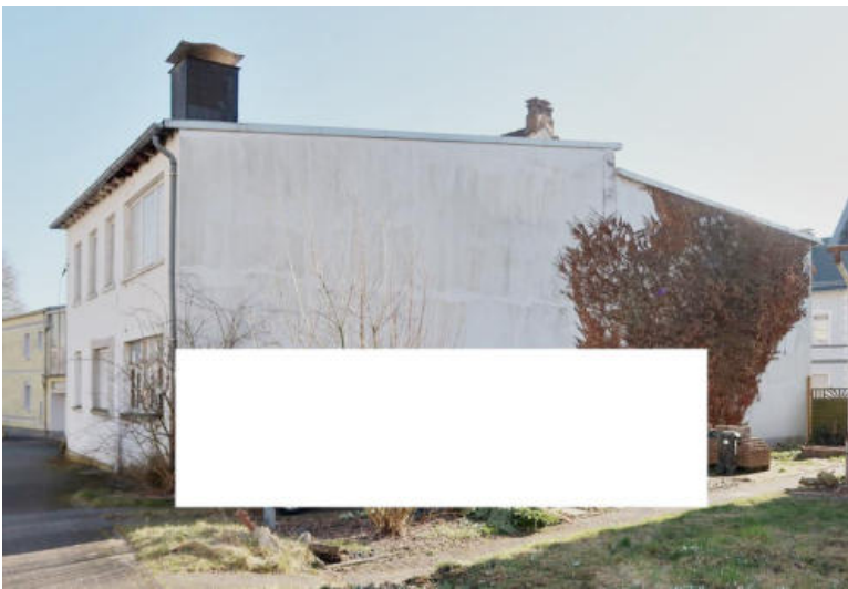
Ansicht südwestliche Giebelseite des Anbaus auf Flurst. 7, Flachdach Richtung Wieser Weg und Pultdach zur Werdohler Straße. Nicht sichtbar im Bild: Grenzständige Anbauten des Nachbarn, Werdohler Str. 28 - Carport und Gartenhaus.
