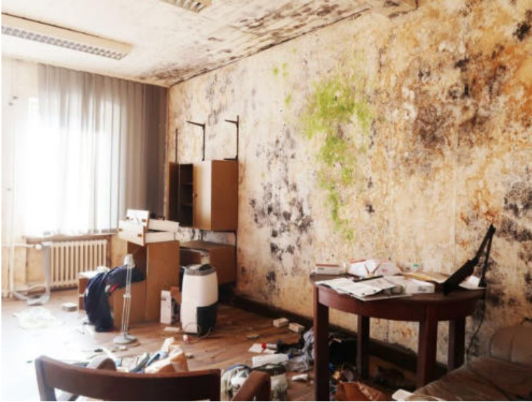
Büroraum links vom Eingang mit erheblichen Feuchtigkeitseinwirkungen, Schimmel und Algenbildung.
