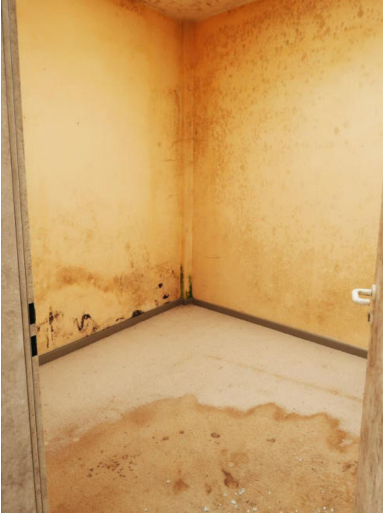
Büroraum. Feuchte in den Wandbereichen und im Boden.
