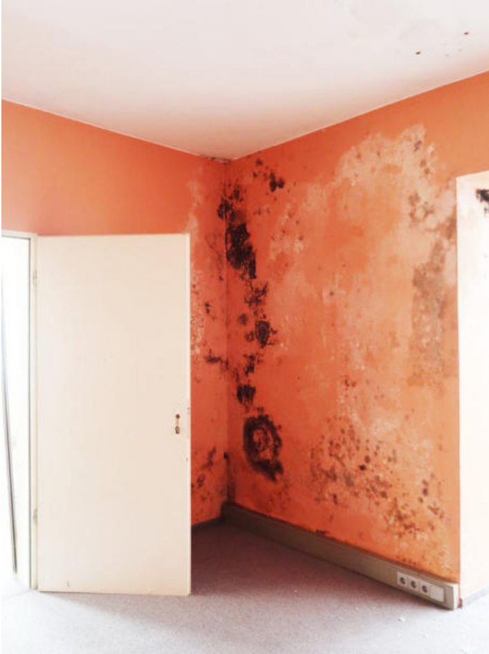
Büroraum mit massivem Feuchteintrag und Schimmelbildung.
