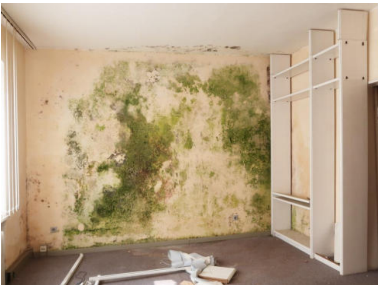
Büroraum im Obergeschoß mit massivem Feuchteintrag und Algenbildung.
