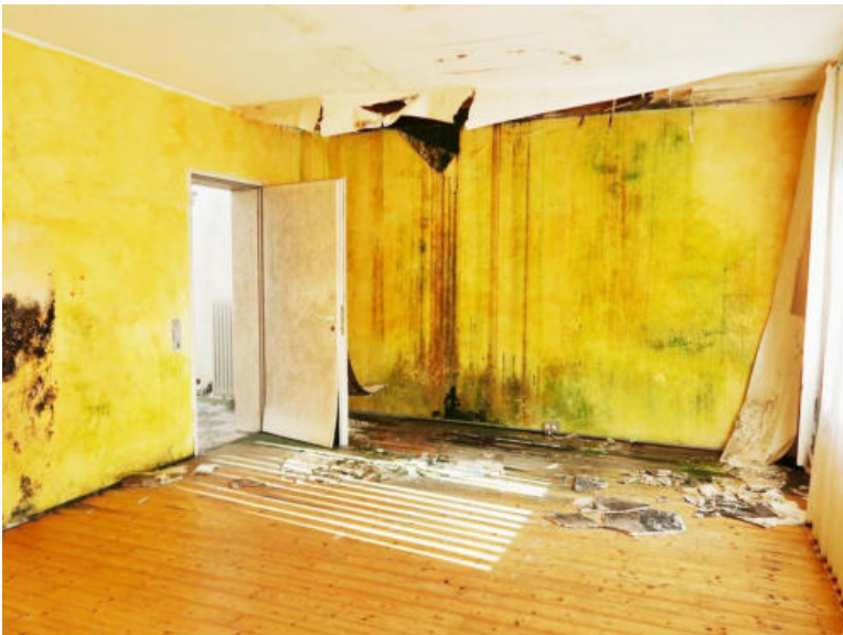
Völlig durchfeuchtete Innenwand, abgelöste Deckenbekleidungen im Innenwandnahen Bereich.
