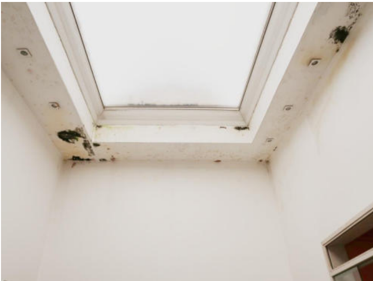
Feuchtigkeitseinwirkungen und Schimmelbildung auch im Bereich der Lichtkuppeln.
