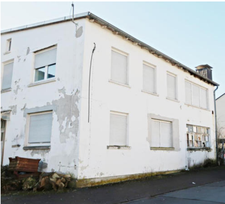
Ansicht Anbau vom Wieser Weg aus. Großflächige Schäden an der Beschichtung der Fassade, Zerstörtes Stahlrahmen - Fenster im Erdgeschoß.
