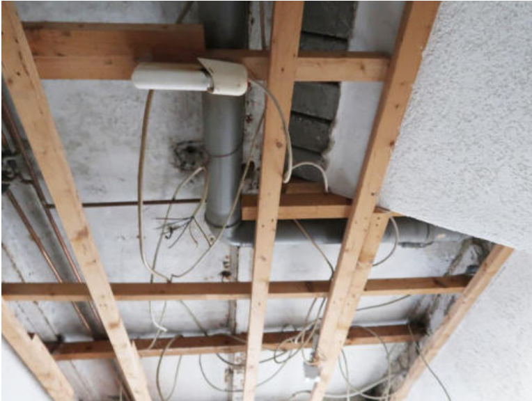
Deckenuntersicht im Flur
