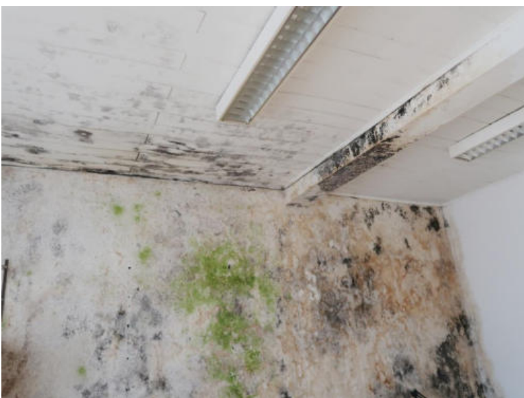
Die Auswirkungen der Feuchtigkeitseinflüsse greifen in den Deckenbereich über.
