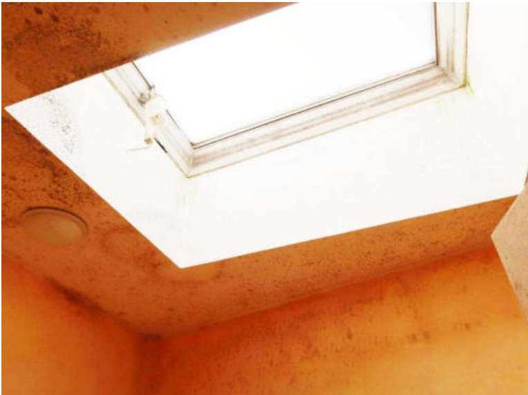
Ebenfalls erhebliche Feuchteinwirkungen um die Lichtkuppel herum im Pultdach.
