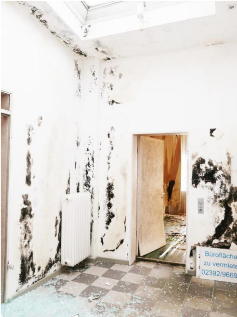
Ein innenliegender Flur im OG mit erheblichen Feuchtigkeitseinwirkungen und Schimmelbildung.
