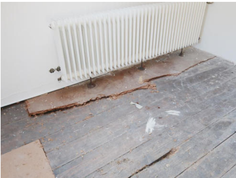
Notdürftig reparierte Fehlstellen im Boden
