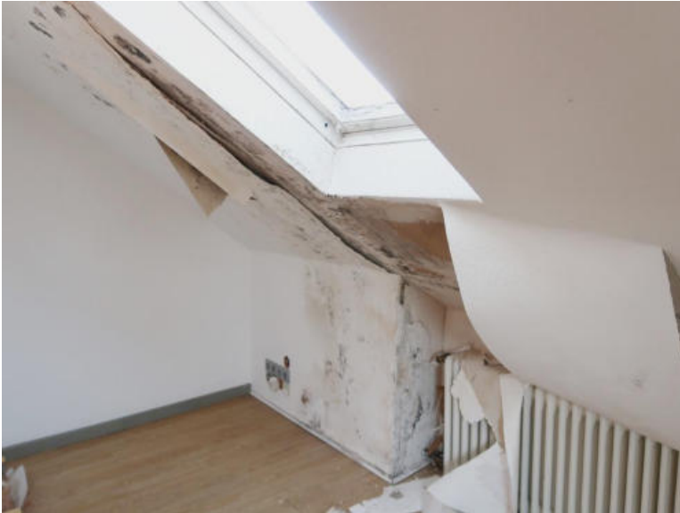
Feuchteschäden im Bereich der Dachgauben
