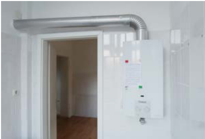
Gas-Durchlauferhitzer im Bad
