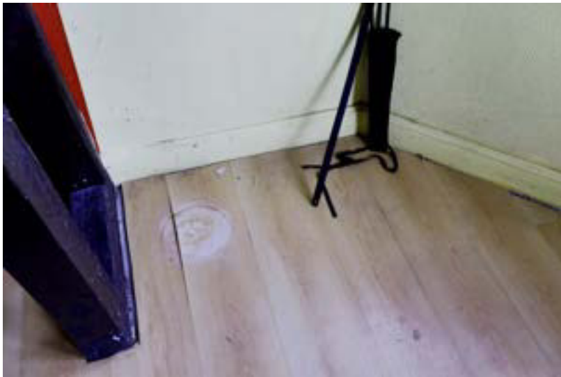
Schäden am Bodenbelag
