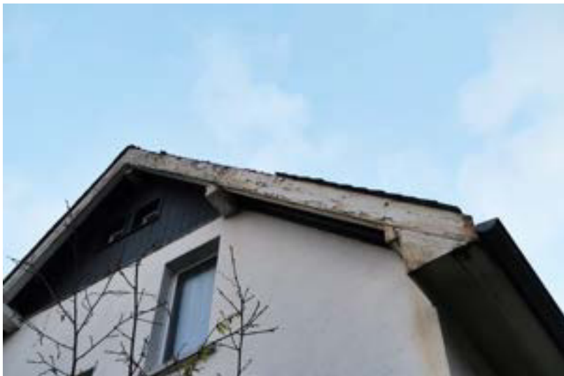
Holzbauteile am Dachüberstand sanierungsbedürftig
