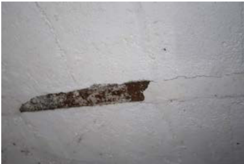
Korrosion an den Stahlträgern der Kappendecke
