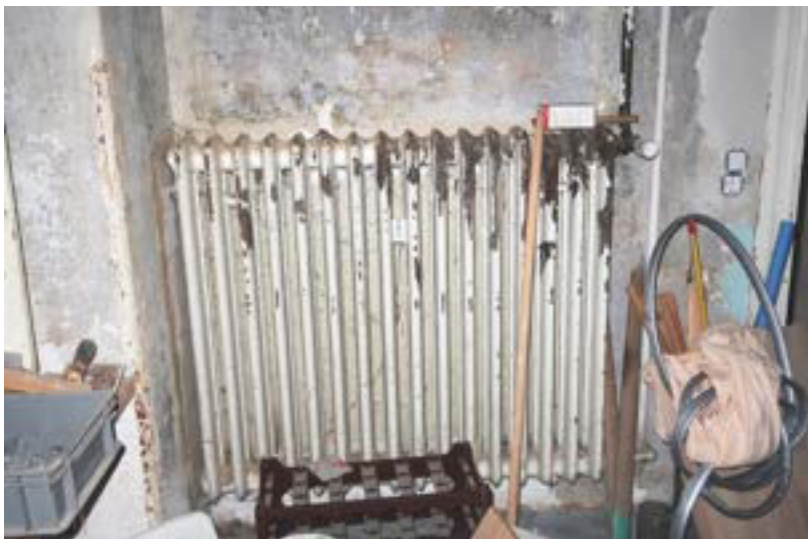
Heizkörper im Büro
