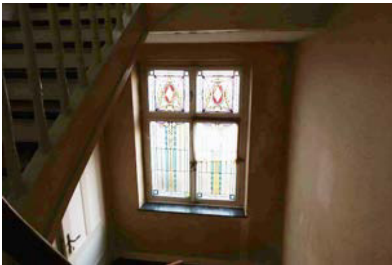
Treppenhaus – Podest zwischen OG und DG, zerstörtes Fenster
