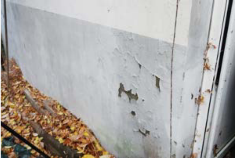
Schäden an der Beschichtung der Fassade (Beispiel)
