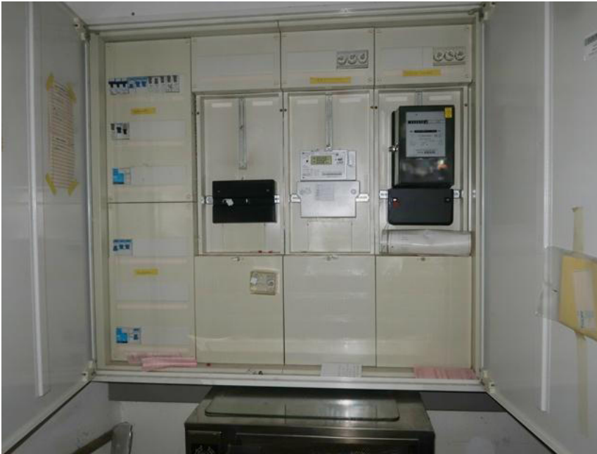
Zählertafel für 2 Wohnungen.
