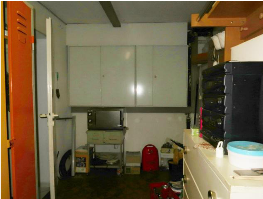
Kellerraum mit Zählerschrank Elektro
