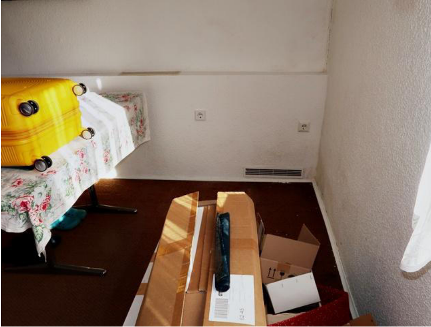
Die Vorsatzschale im unteren Wandbereich mit Lüftungsschlitz. Im unteren Wandbereich sichtbarer und messbarer Feuchteintrag.
