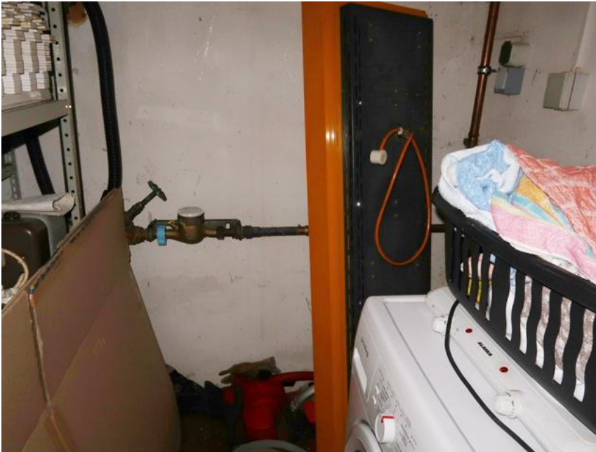
Wasserzähler im Kellerraum
