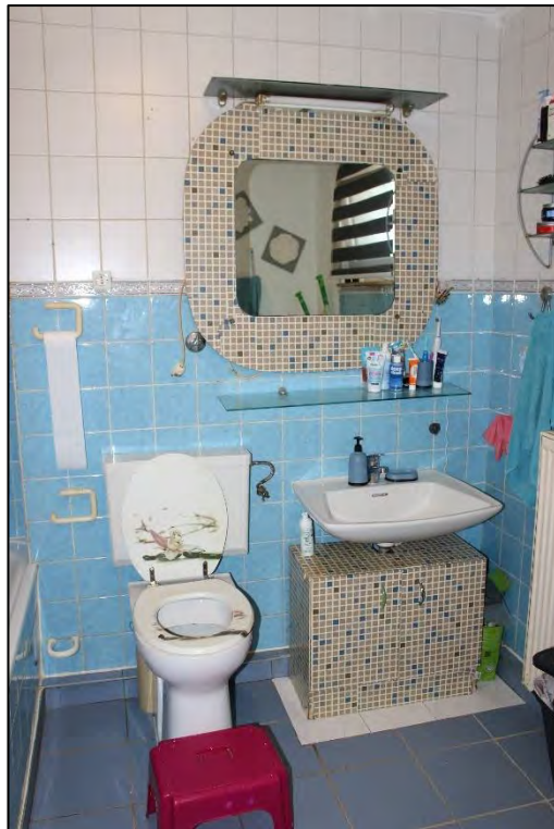
Foto Nr. 103: WE Nr. 18, 5. OG mittig, Bad
