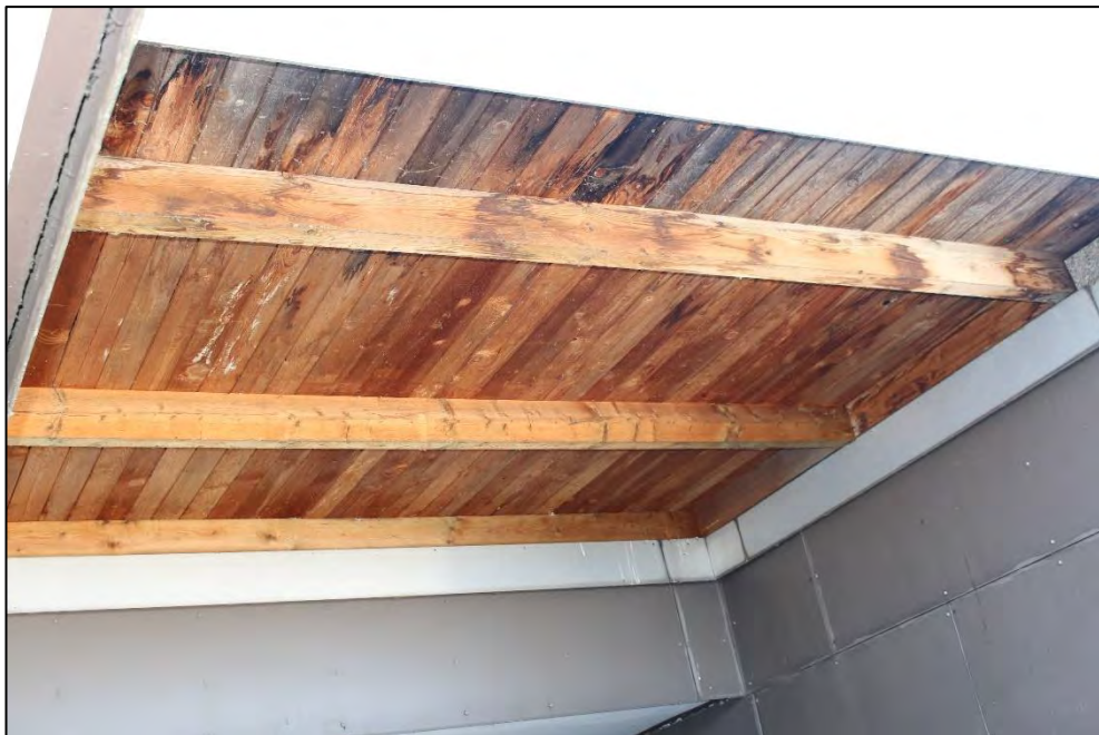
Foto Nr. 124: 6. OG, Flachdach oberhalb Außentreppe / Feuchteschaden
