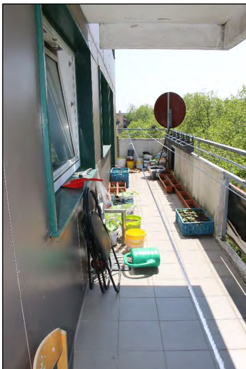
Foto Nr. 112: WE Nr. 20, 5. OG hinten links, Balkon
