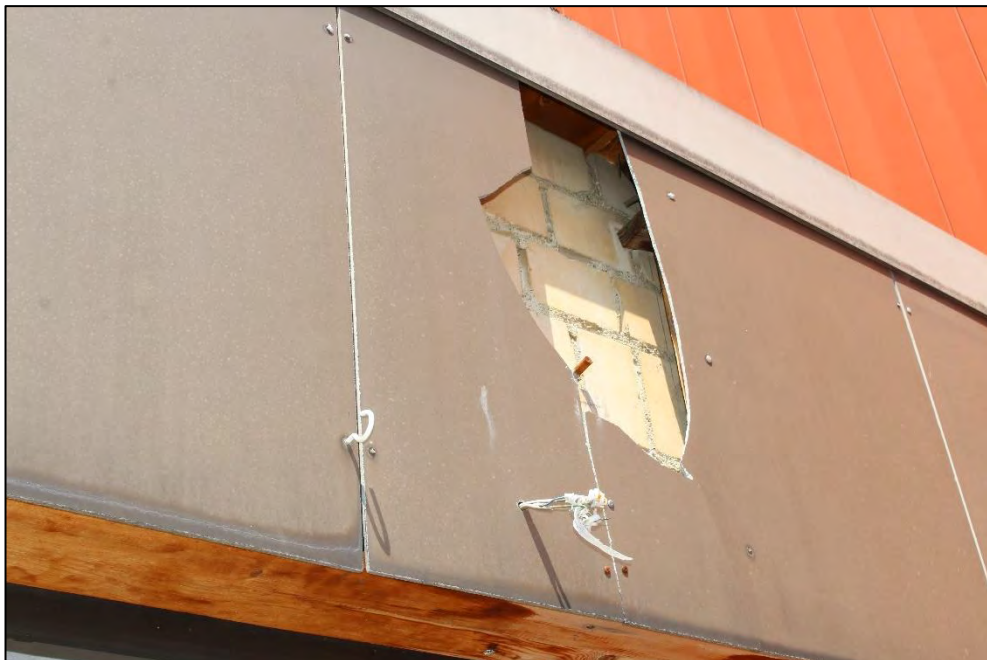
Foto Nr. 128: WE Nr. 22, 6. OG links, Balkon / Schäden Außenwandverblendung
