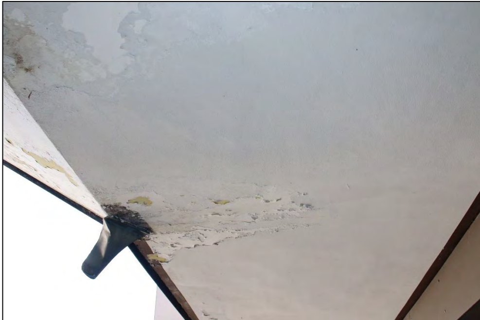
Foto Nr. 97: Laubengang / Schäden Decke
