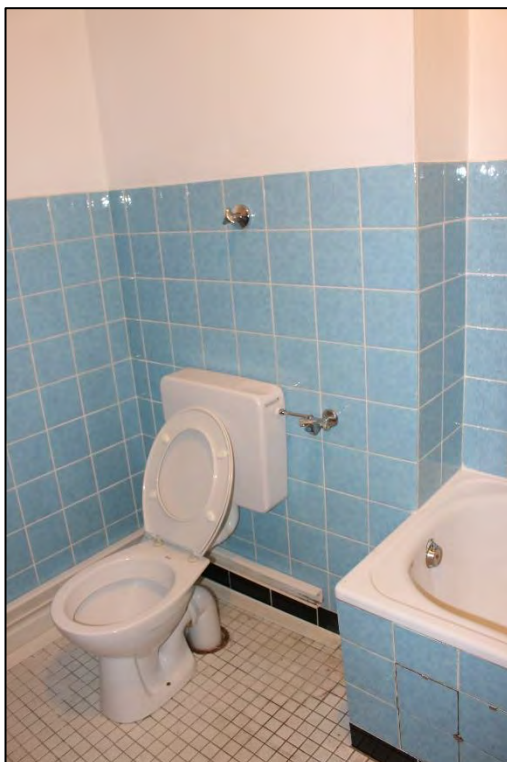
Foto Nr. 82: WE Nr. 13, 4. OG rechts, Badezimmer - Foto vom 10.02.2022
