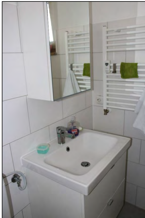
Foto Nr. 53: WE Nr. 6, 2. OG mittig, Bad
