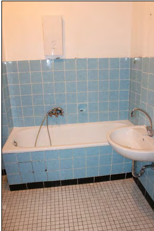
Foto Nr. 81: WE Nr. 13, 4. OG rechts, Badezimmer - Foto vom 10.02.2022
