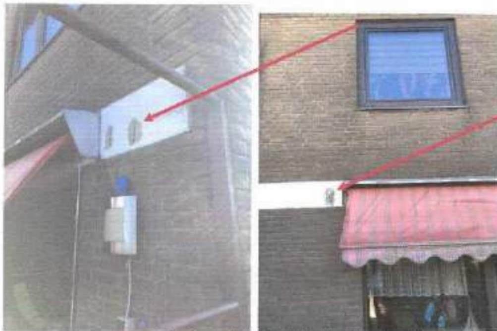
Bewehrungsseisen liegen frei (rückwärtige Fassade)
