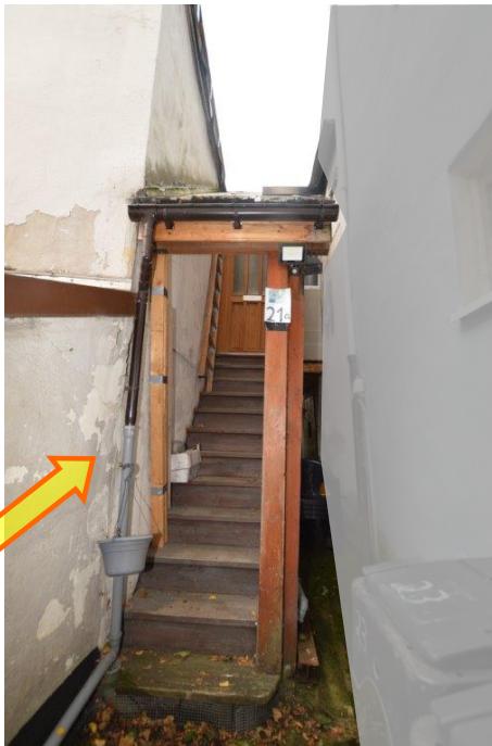
Rckseite mit Holztreppe zum Obergeschoss und Auenputzschden (Beispiel)
