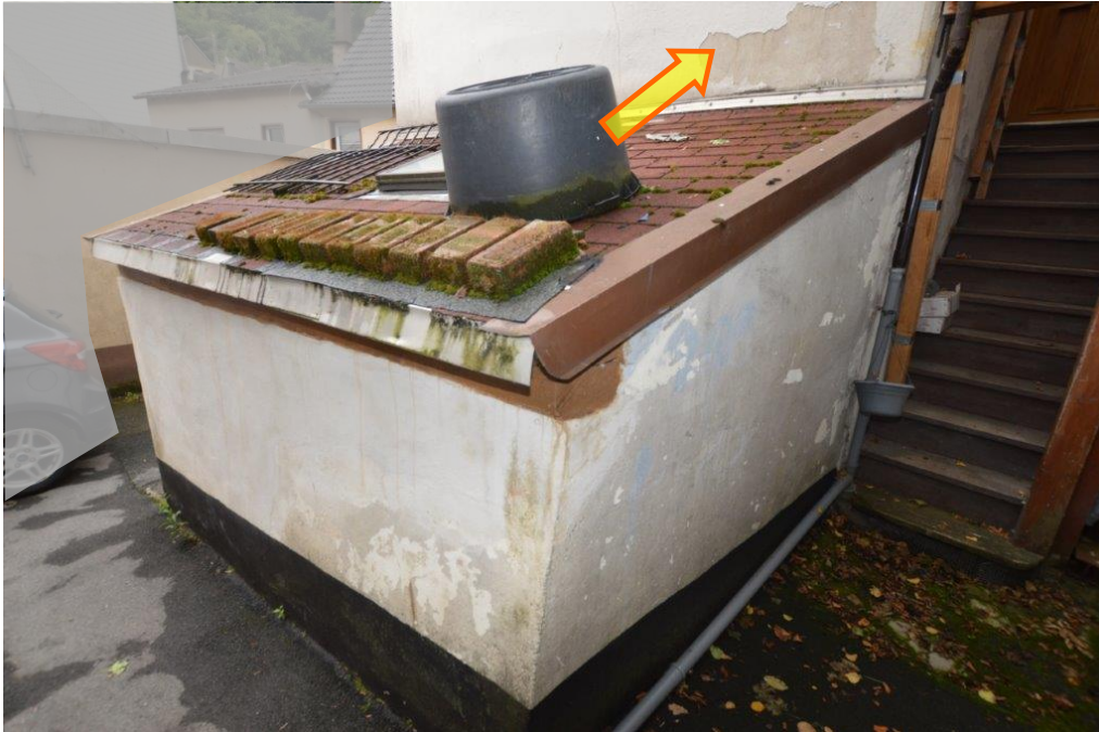
Eingeschossiger Anbau und Auenputzschden (Beispiel)
