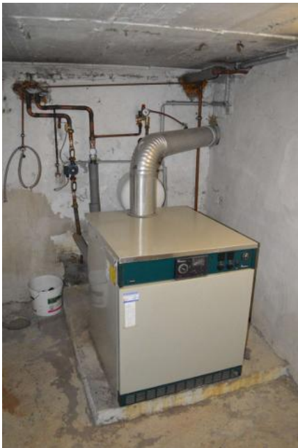
Bild 11: Heizungsanlage (im Wohn- und Geschäftshaus)
