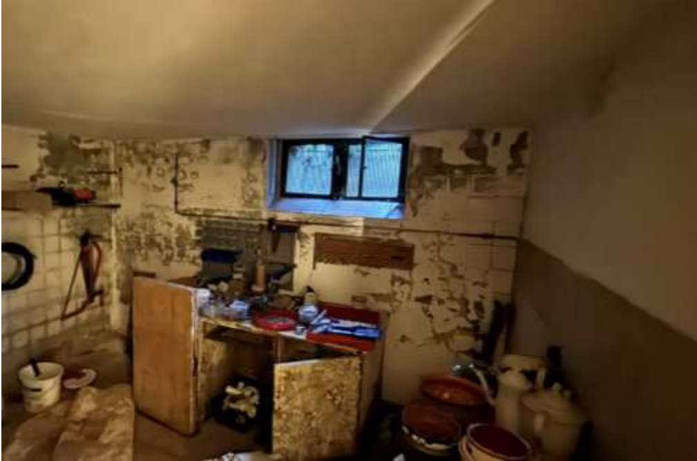
Feuchtigkeit an Kelleraußenwand
