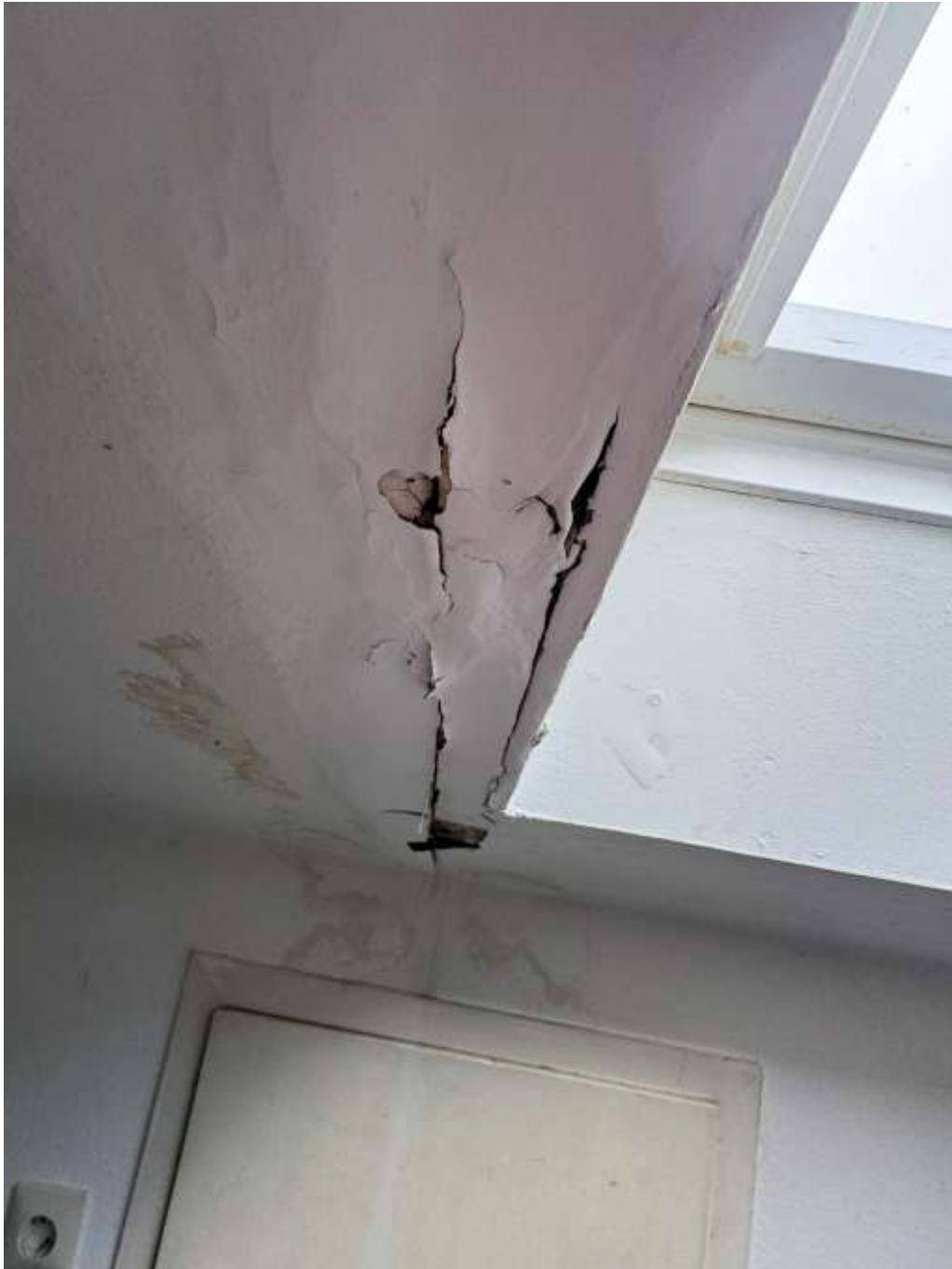
Feuchtigkeitsschaden im Dachgeschoß
