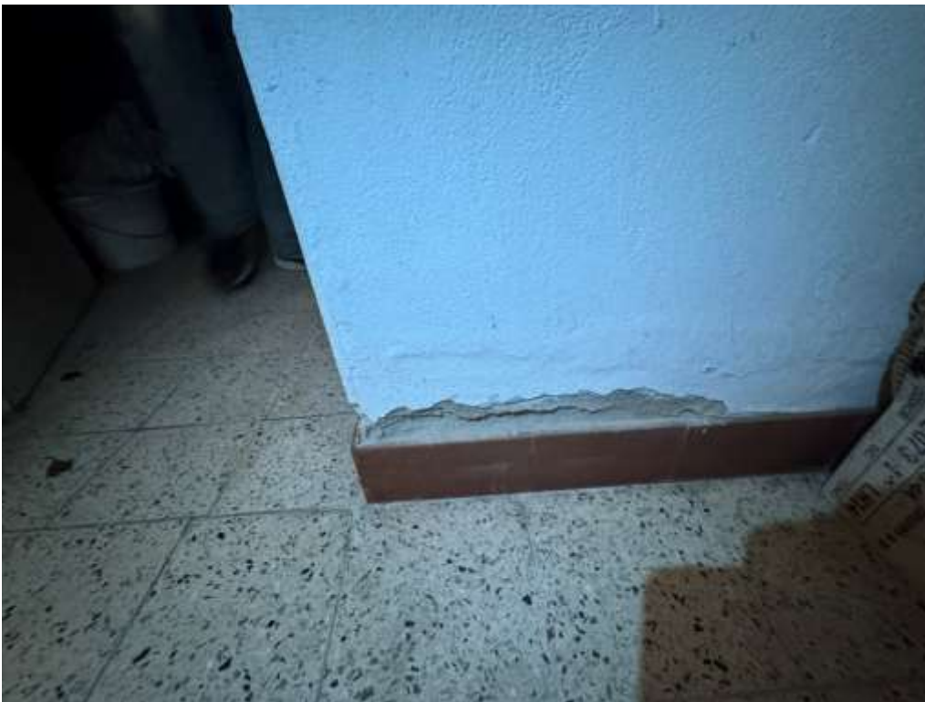
Putzabplatzungen an Kellerinnenwand
