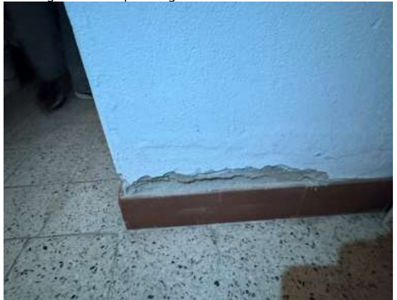
Feuchtigkeit und Abplatzungen an Kellerinnenwand
