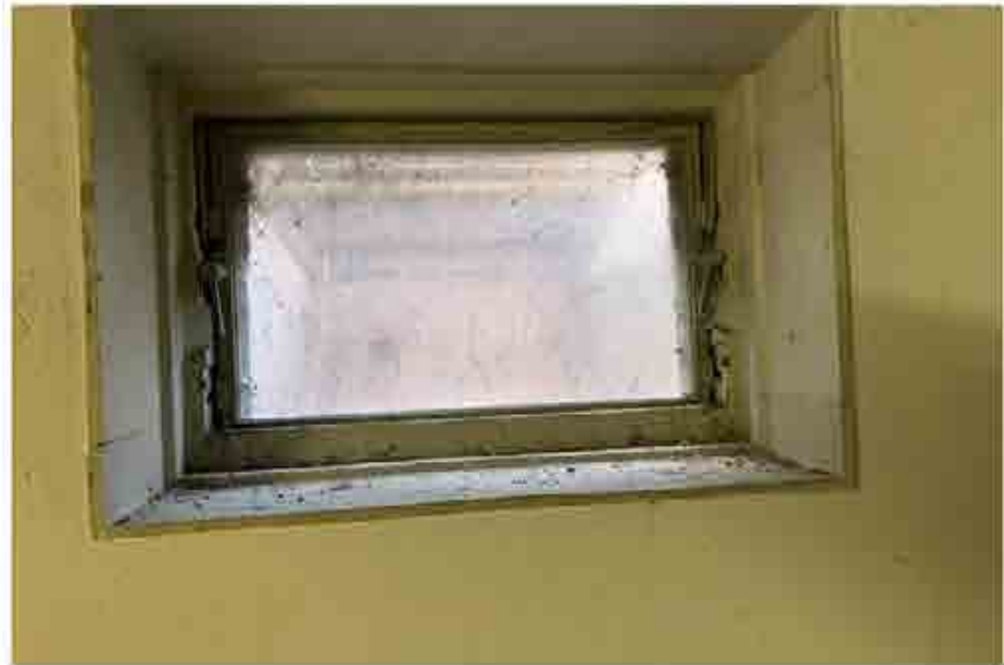
KG, Hobby, Detail Fenster (Foto aus dem Gutachten vom 24. März 2023)
