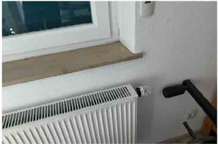
DG, Boden, Detail Fenster (Foto aus dem Gutachten vom 24. März 2023)
