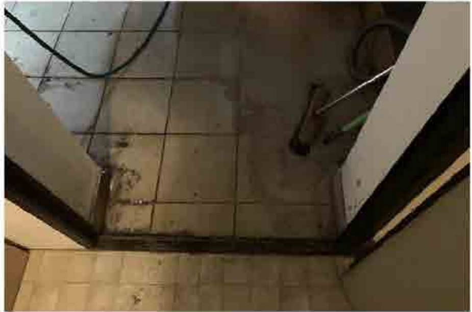
KG, Flur, Übergang zu Heizen/Waschen/ Trocknen (Foto aus dem Gutachten vom 24. März 2023)
