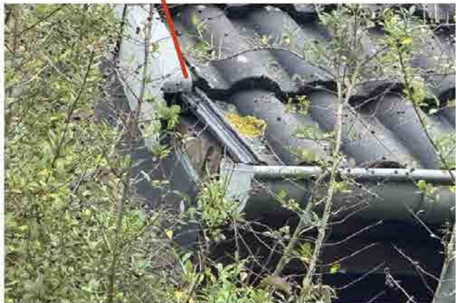
Detail Dach, fehlender Betondachstein (Foto vom 17. Oktober 2025)
