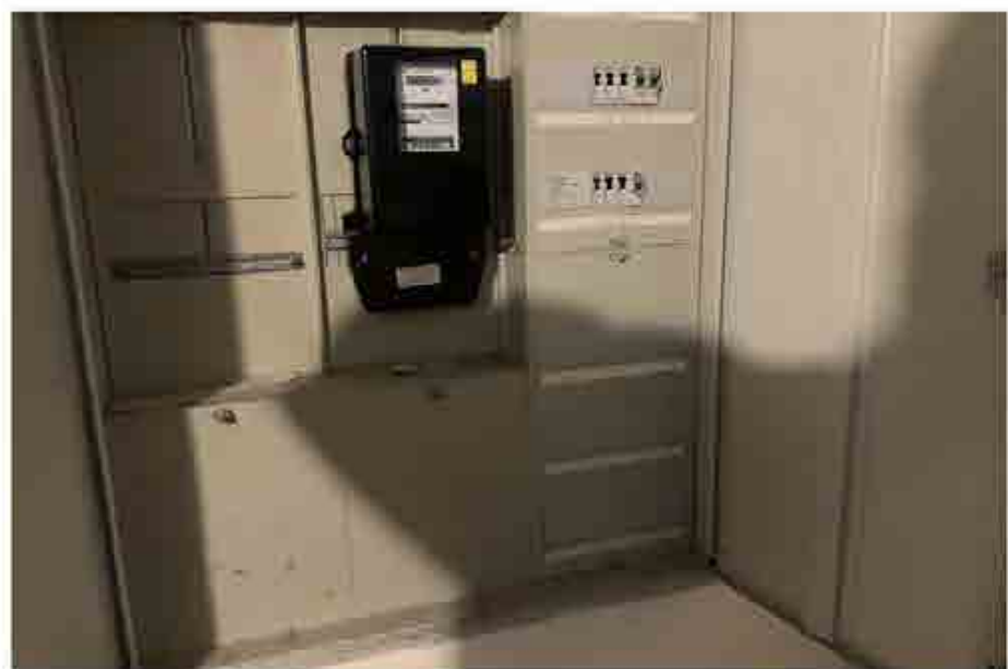
Stromkasten (Foto aus dem Gutachten vom 24. März 2023)
