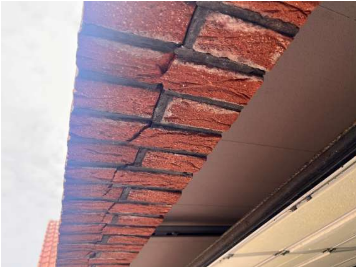
Gebrochener Sturz am Garagentor
