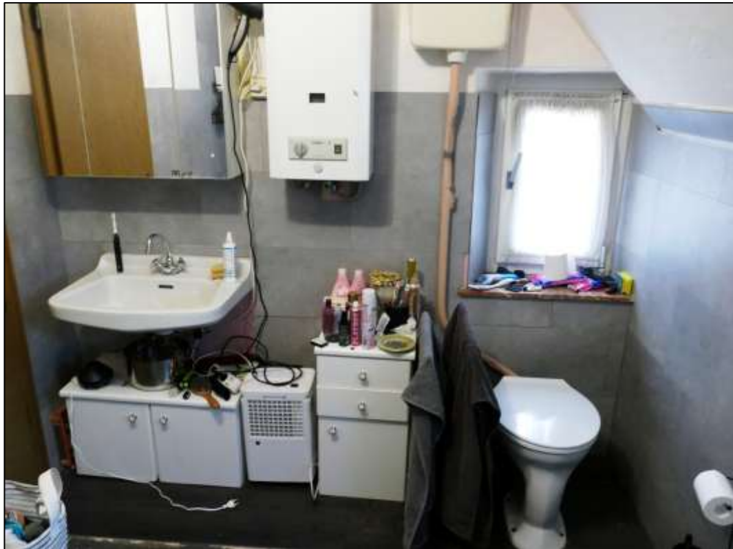
Sanitäre Anlagen tlw. veraltet (OG)
