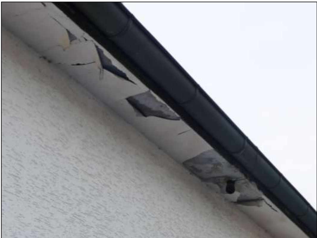
Putzschäden am Dach
