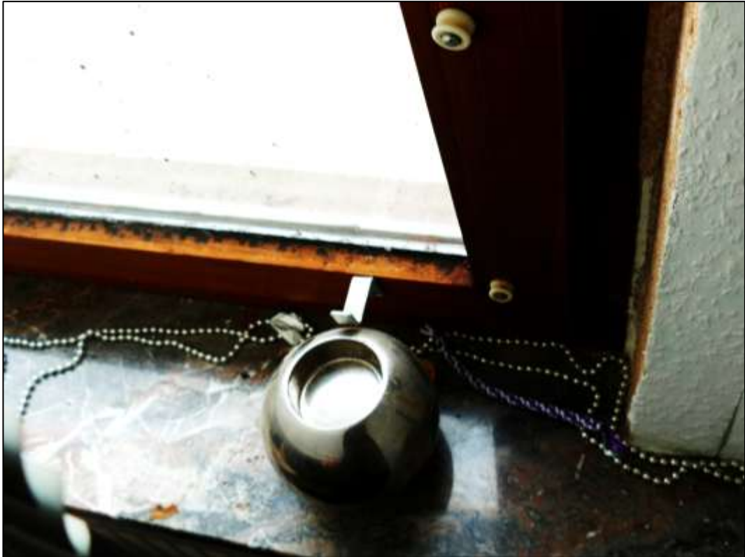
Feuchtigkeitsschäden mit Schimmelbildung
