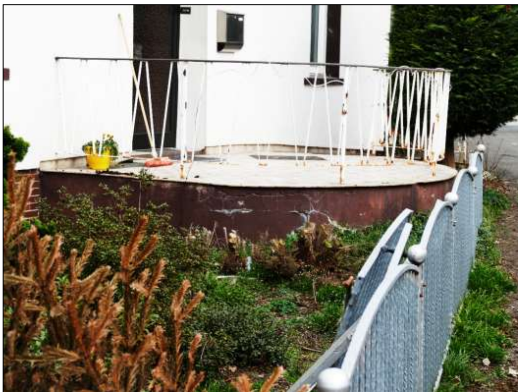
Schadhafter Betonsockel Eingang
