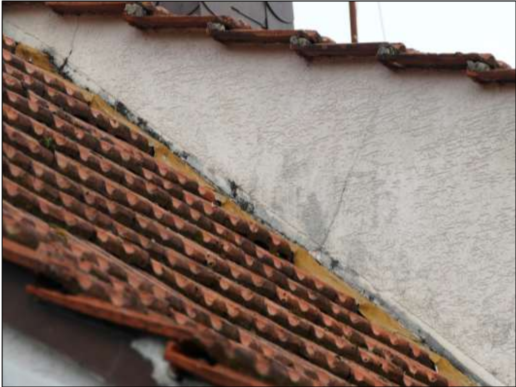
Riss und Feuchtigkeitsschaden im Bereich der Gaube
