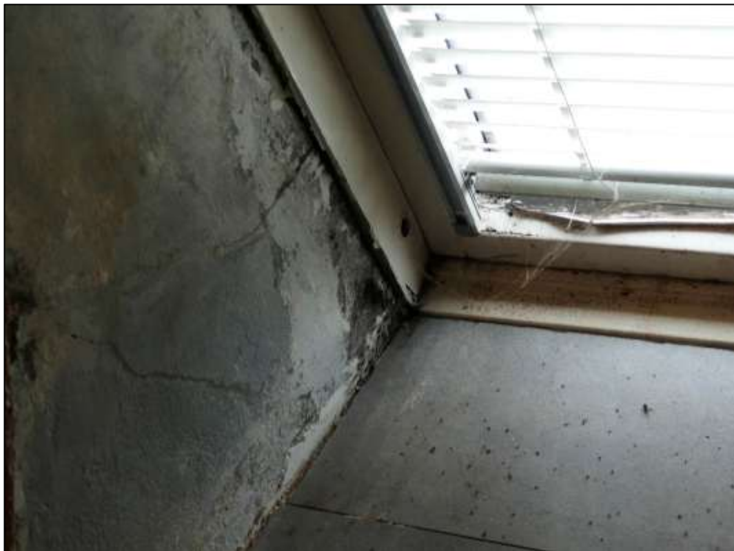
Schäden am Fenster (WC im DG)
