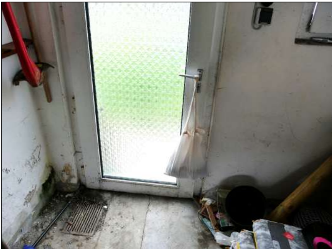
siverse Schäden mit tlw. Schimmelbildung
