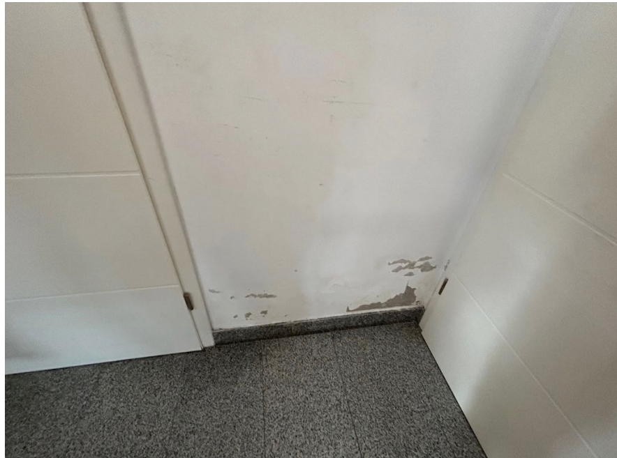
Schäden im Wandbereich der Erdgeschoßwohnung Haus Nr. 34
