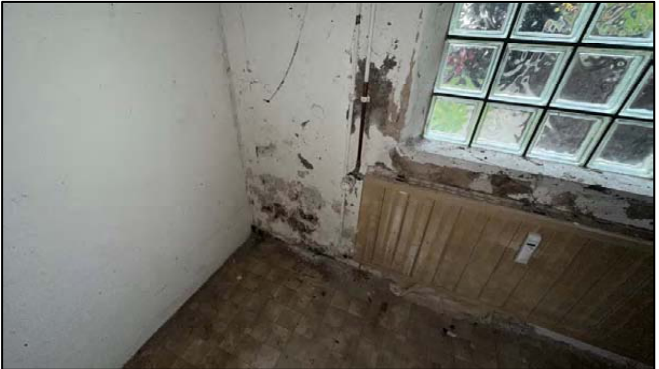
Gewerbeeinheit Nr. 1: Feuchtschäden im Bereich Lager 2
