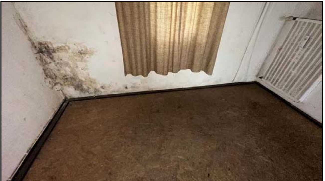
Gewerbeeinheit Nr. 1: Feuchtschäden im Bereich Büro
