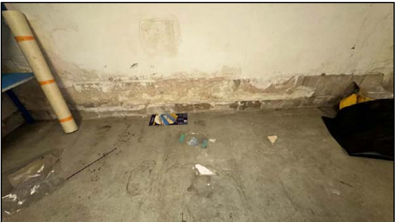
Feuchtschäden im Lager – Bürogebäude
