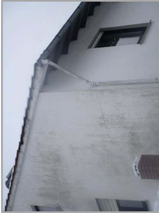
Fassade, verschmutzt / Risse
