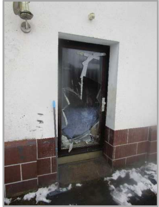
Hintertür, Glasfüllung zerborsten
