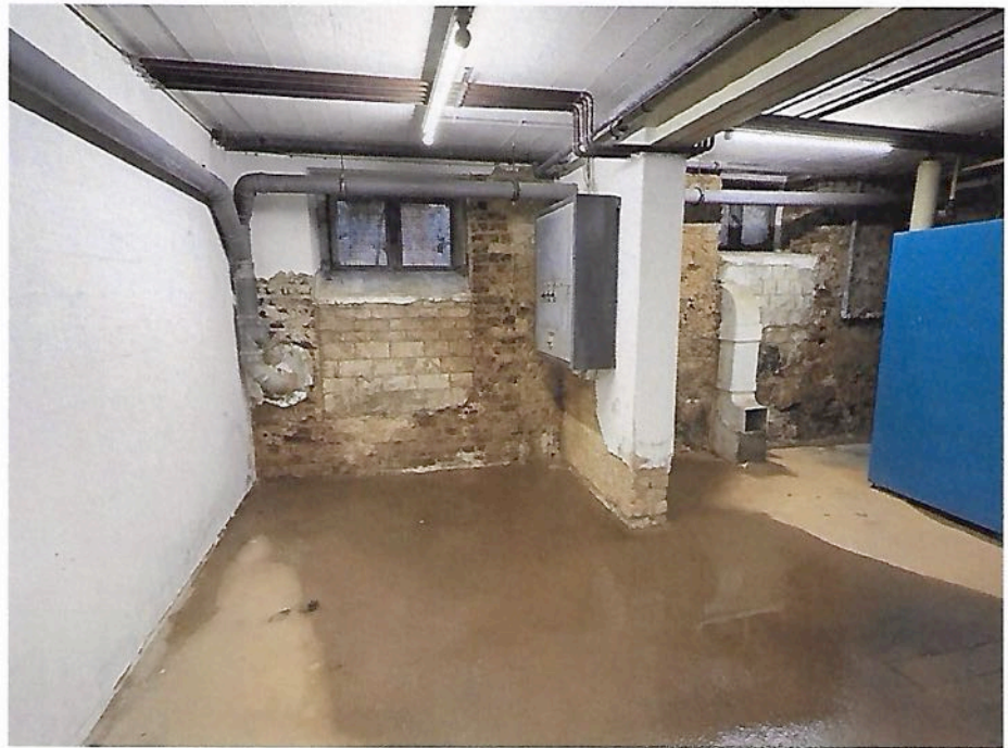
im ehemaligen Heizungskeller stehende Feuchtigkeit
