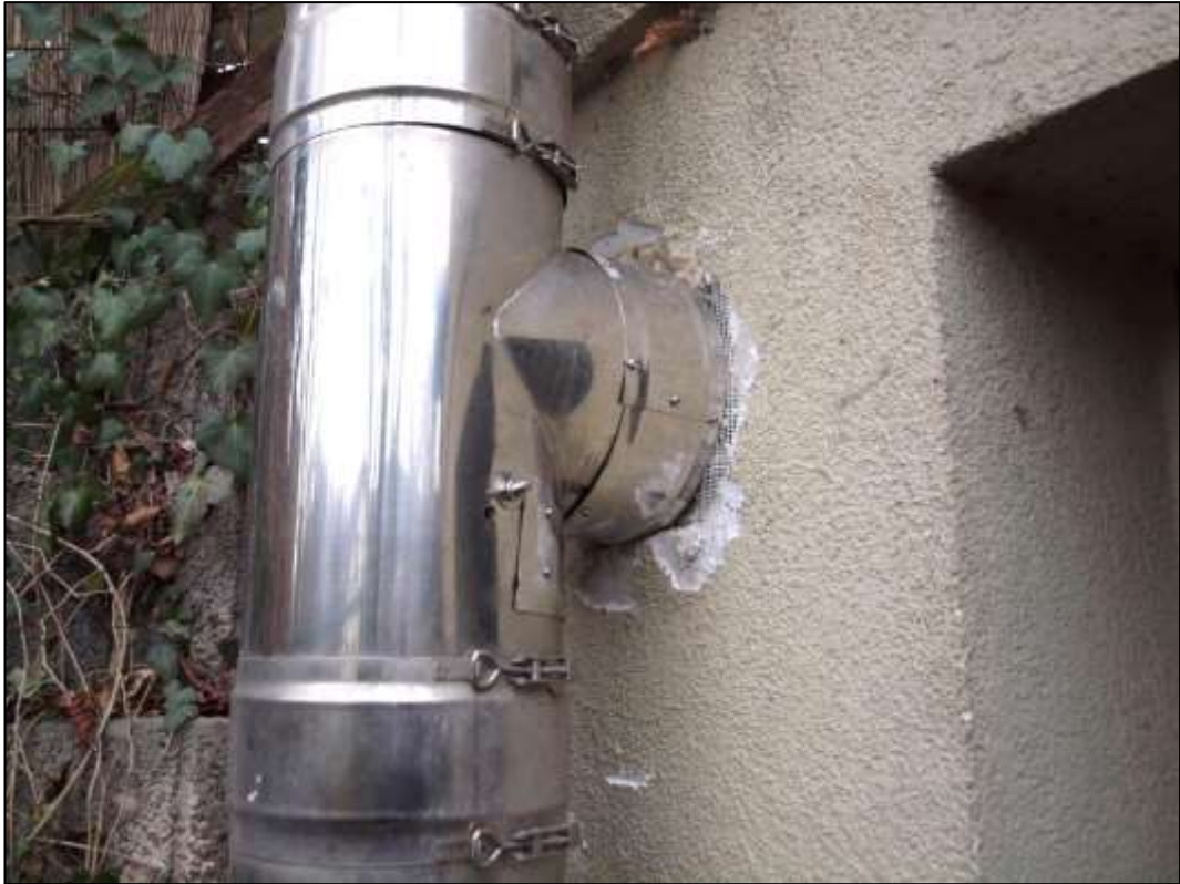
laienhaft montiertes Kaminrohr
