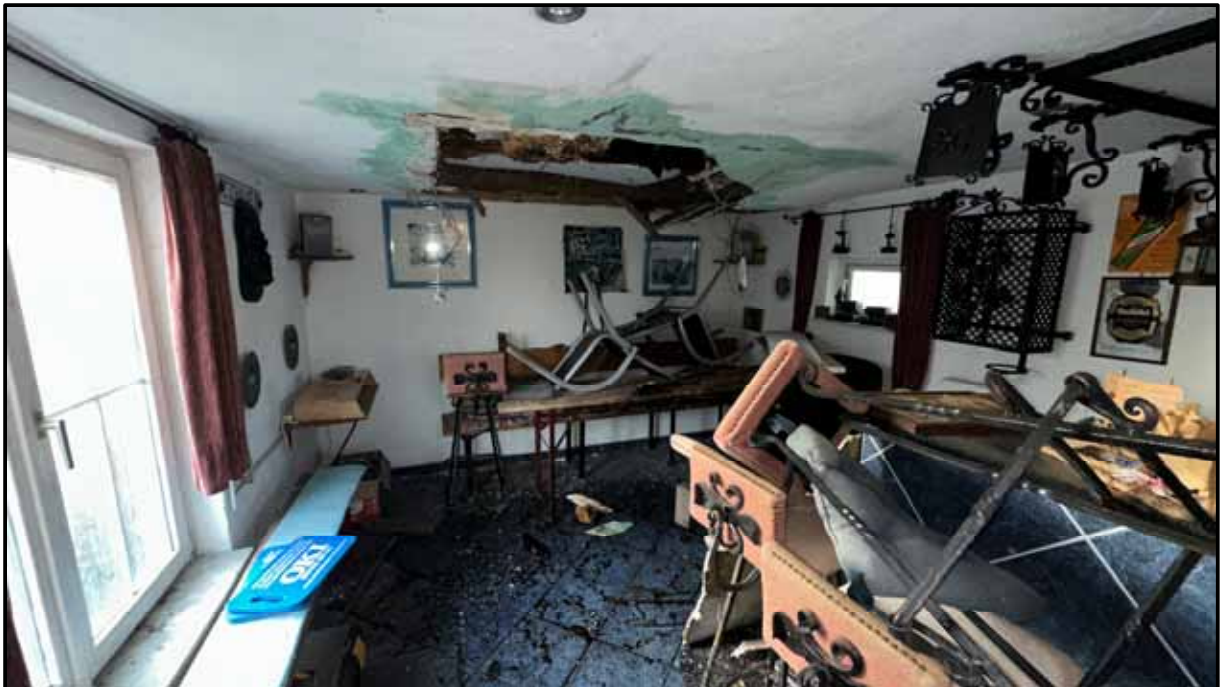
Innenbereich des baufälligen Nebengebäudes
