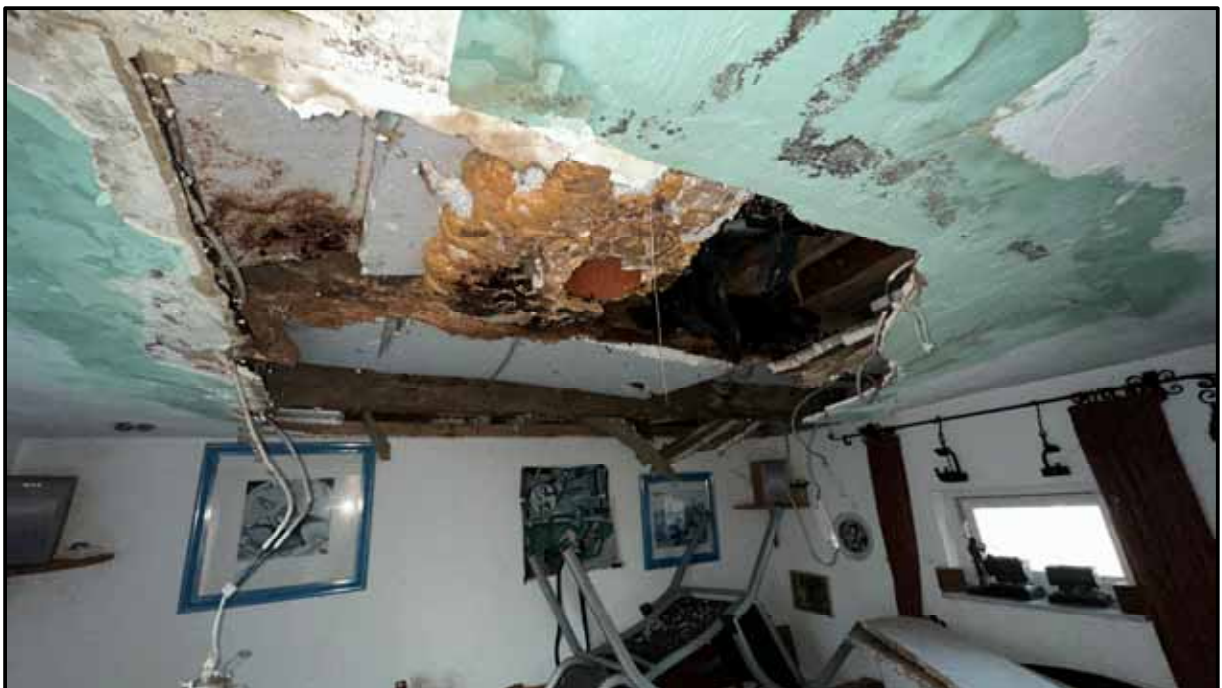
Innenbereich des baufälligen Nebengebäudes
